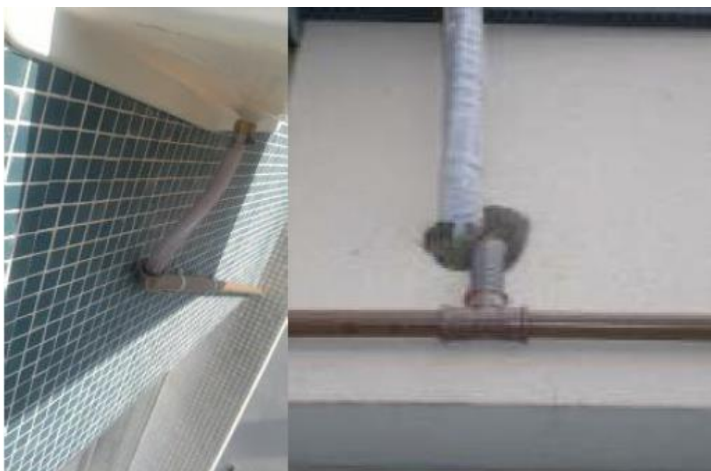
Figura 7: Tubo de PVC que liga o dreno ao reservatório.
