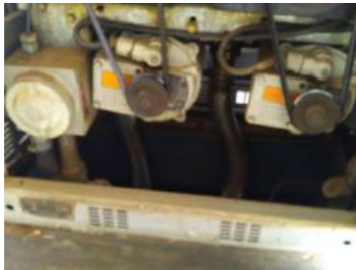
Figura 18: Sump da bomba.
