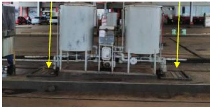
Figura 20: Sumps do filtro de diesel.
