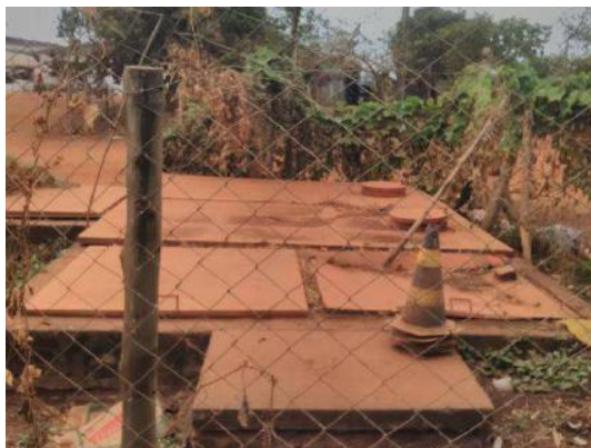
Figura 14: Sistema separador de água e óleo (SAO).
