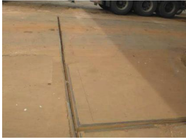
Figura 15 - Piso impermeabilizado em concreto com canaletas de contenção.
