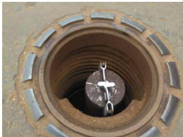
Figura 17: Detalhe do sump da boca de descarga do tanque com dispositivo de descarga selada.
