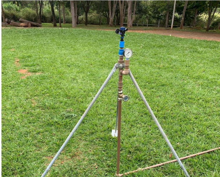
Figura 4. Manômetro e registro de gaveta instalado. Fonte: Autor (2025).
