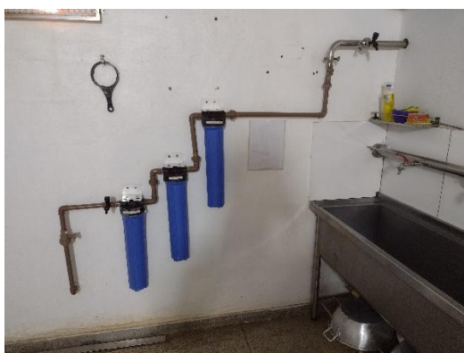
Figura 9: Sistema de Filtração de Água (Filtro Poli Micra 5, Filtro de Carvão e Filtro Poli Micra 1)
