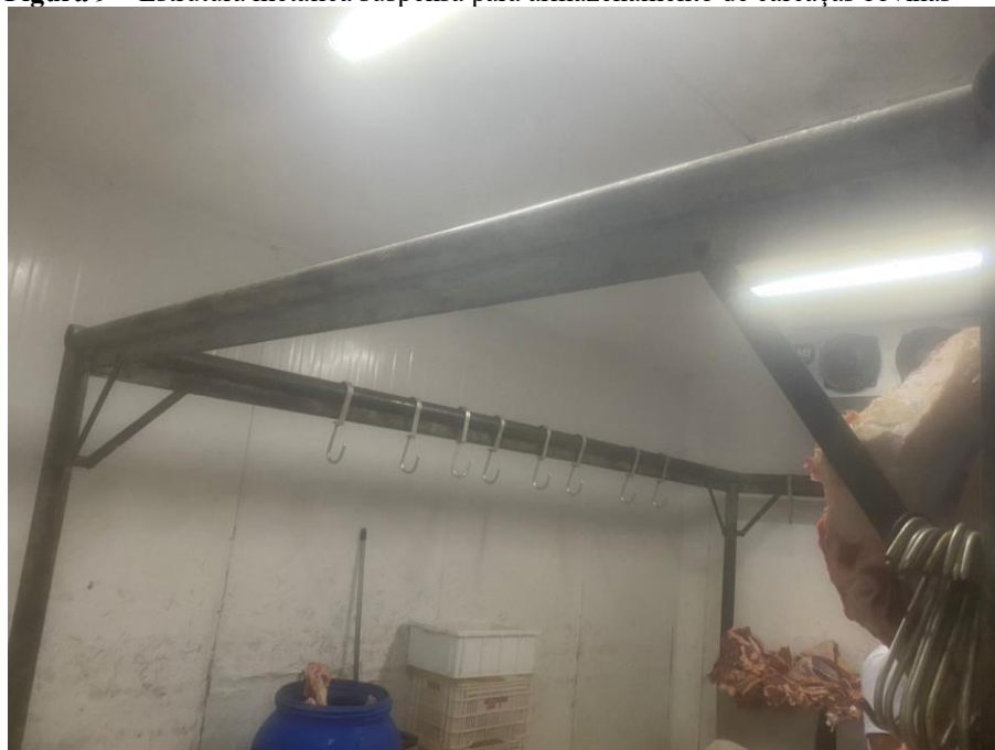
Figura 9 – Estrutura metálica suspensa para armazenamento de carcaças bovinas
