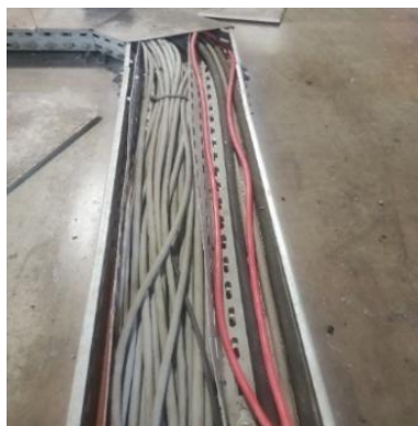
a) Cabo de rede junto com condutor elétrico.
