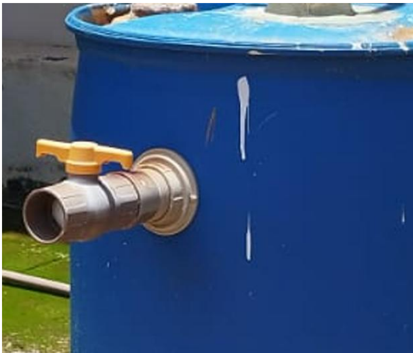
Figura 11 - Detalhe da conexão lateral do biodigestor
