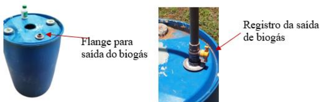
Figura 5 – Detalhe das conexões instaladas
