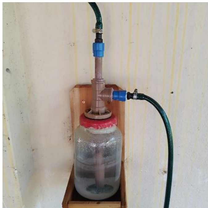
Figura 13 - Filtro de gás sulfídrico
