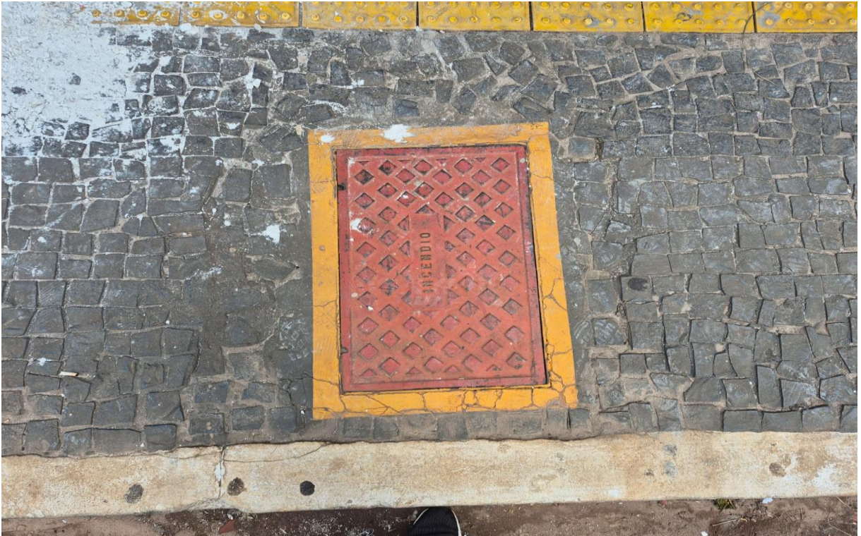
Figura 15 - Hidrante Urbano Subterrâneo. Fonte: Próprio autor
