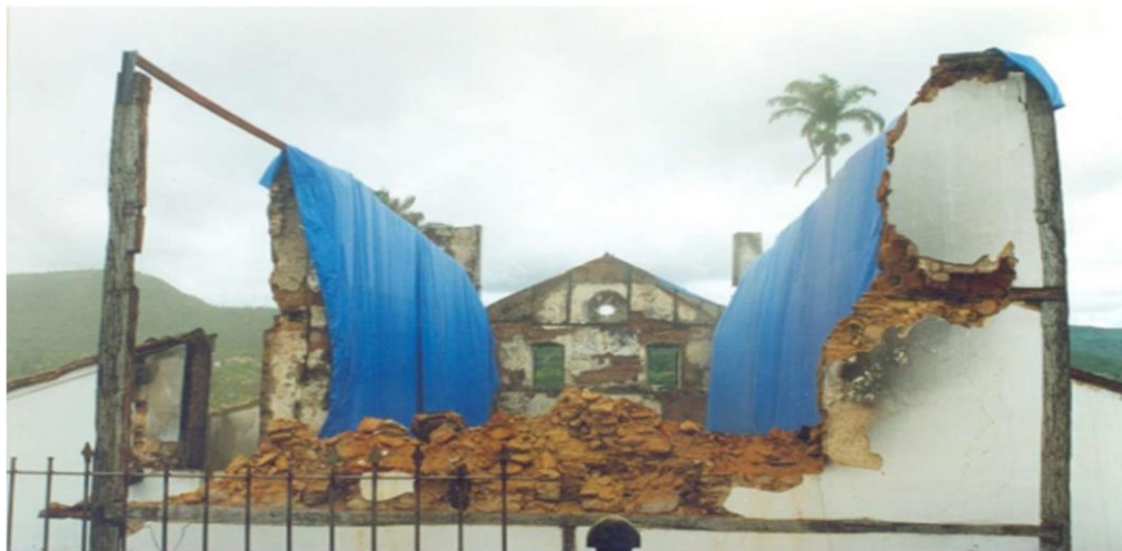
Figura 3 - Igreja Matriz de Pirenópolis/GO após o incêndio de 2002, vista da fachada posterior Fonte: MINERVINO et. al, 2021
