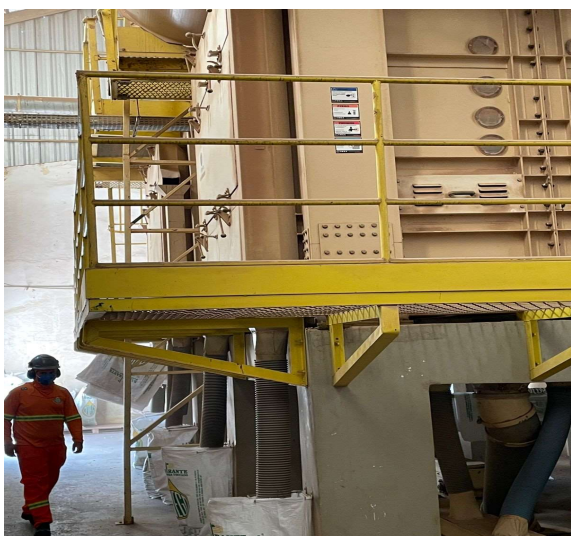
Figura 11 – Sistema de pré-limpeza dos grãos de soja na unidade armazenadora
