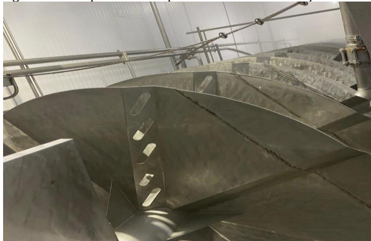
Figura 10 - Tanque Chiller de pré resfriamento de carcaças - Linha 1
