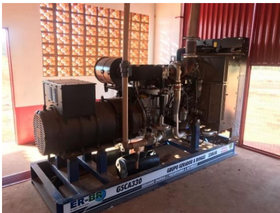
Figura 5. Grupo Motor Gerador a biogás de 330 kVA da ERBR Renováveis. Fonte: Autor.
