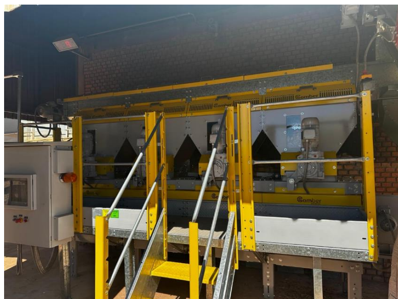
Figura 8 – Caixa de armazenamento com injetores de cavaco
