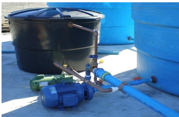
Figura 5: Sistema de caixas para abastecimento do sistema de fertirrigação em lavoura de maracujá.
