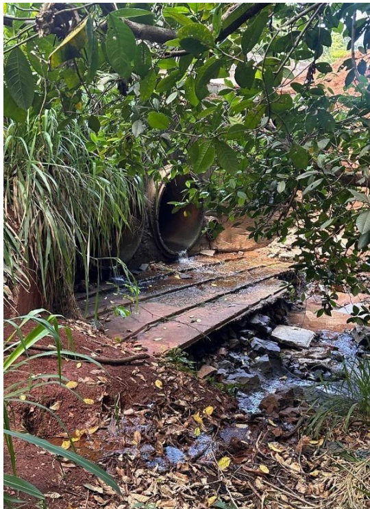
Figura 5: Saída de galeria pluvial com lançamento direto no curso d'água, evidenciando influência urbana no Ponto 1.
