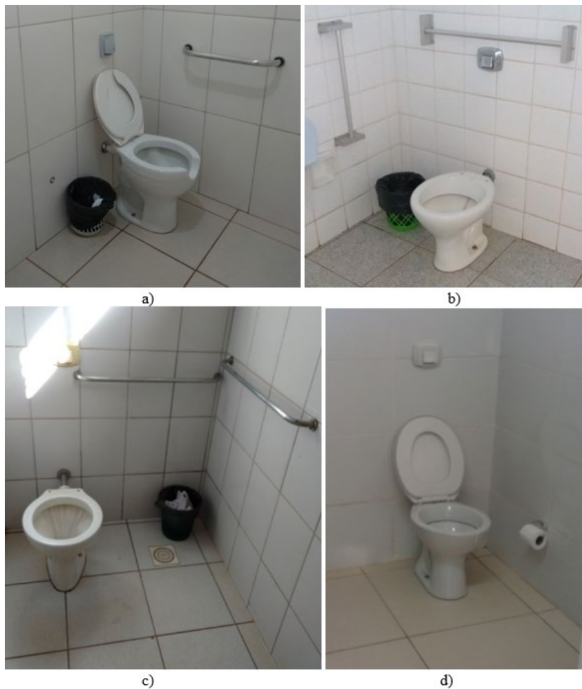
Figura 31 - Banheiros Boxe intermediário - a) Assistência Estudantil; b) Pavilhão Pedagógico II; c) Bloco de salas de aula 34 e 35; d) Bloco de Informática Fonte: Autora (2019).
