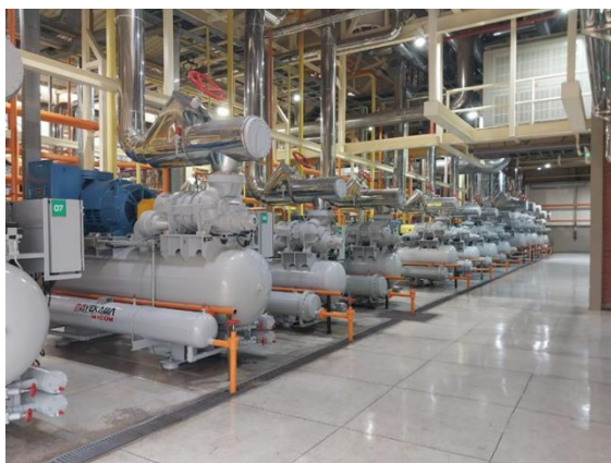
Figura 4: Casa de Máquinas da SSA – equipamentos de controle de temperatura e vazão de água da indústria, 2025.
