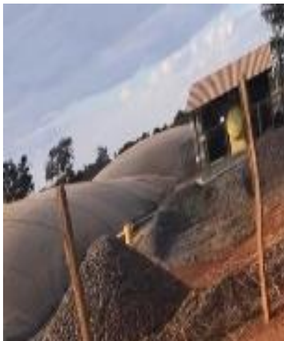
Figura 5 - Vista parcial do biodigestor
