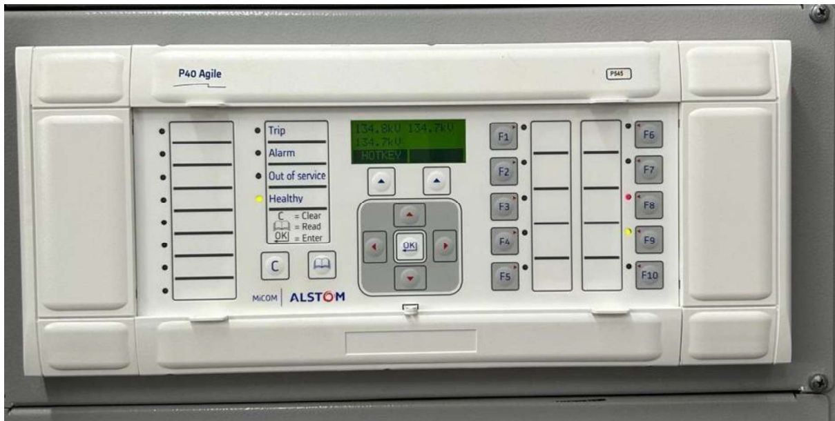
Figura 14: Relé digital. Fonte: Autoria Própria.
