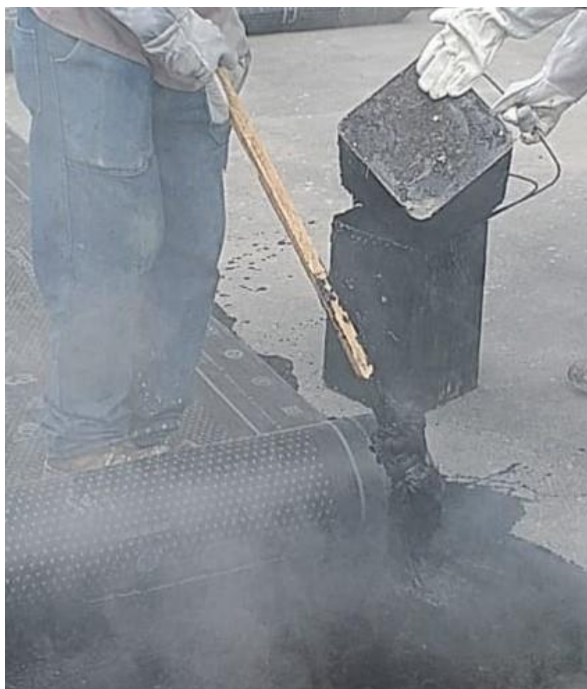
Figura 9- Banho de asfalto quente em substrato p/ aplicação de manta – Estudo de caso 1
