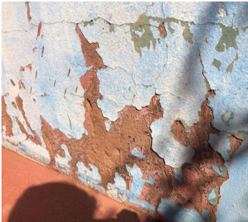
Figura 4 - Manifestação patológica na pintura.
