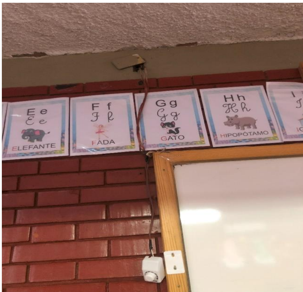
Figura 5 – Falta de local para instalação do interruptor do ventilador.
