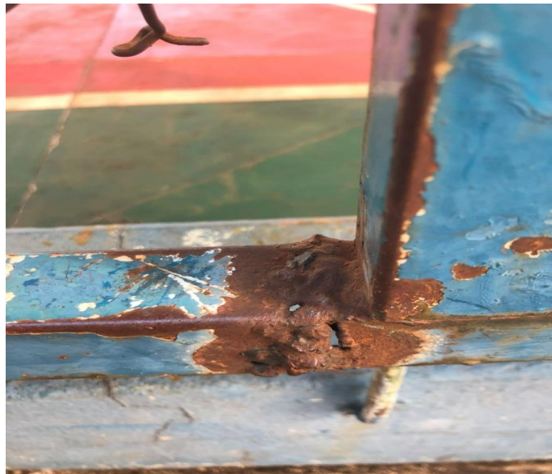
Figura 6 - Oxidação e corrosão.
