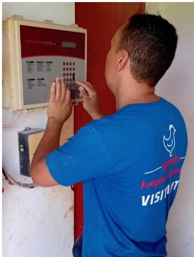
Figura 6- Ajuste de temperatura e umidade no painel de controle do aviário
