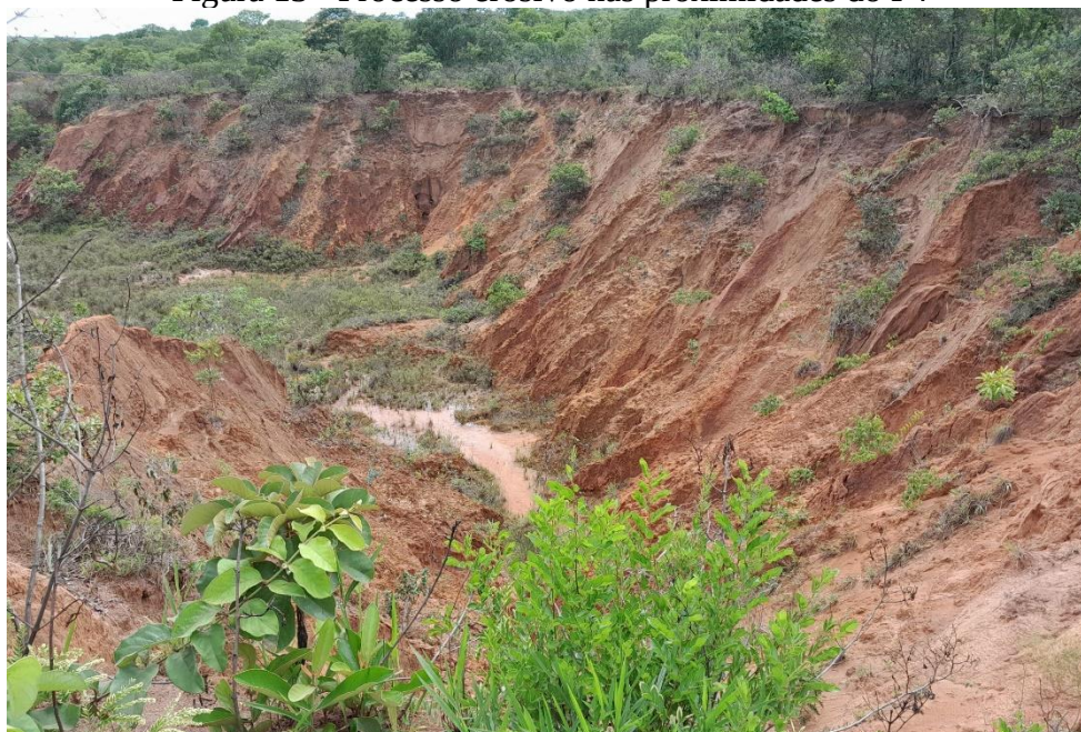
Figura 13 - Processo erosivo nas proximidades do P4
