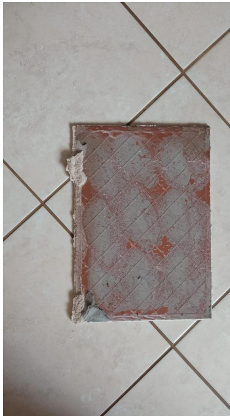
FIGURA 6: Representação do deslocamento em questão da má aplicação da argamassa
