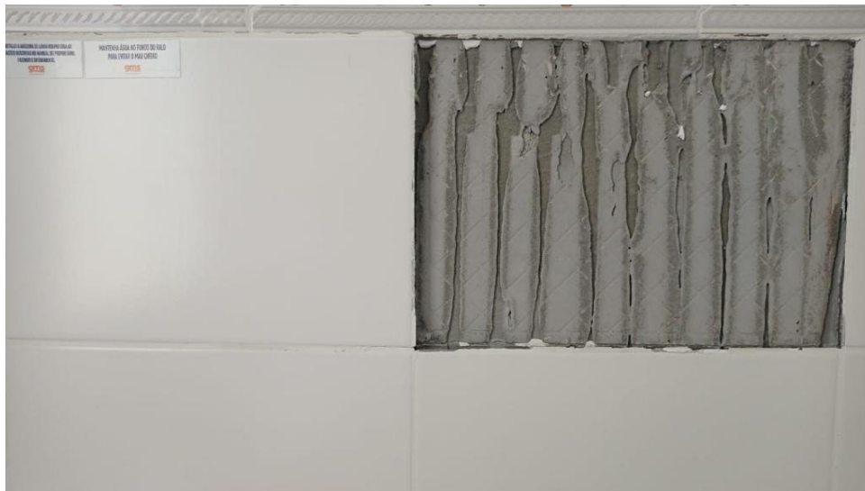
FIGURA 7: Representação do deslocamento em questão da má aplicação da argamassa
