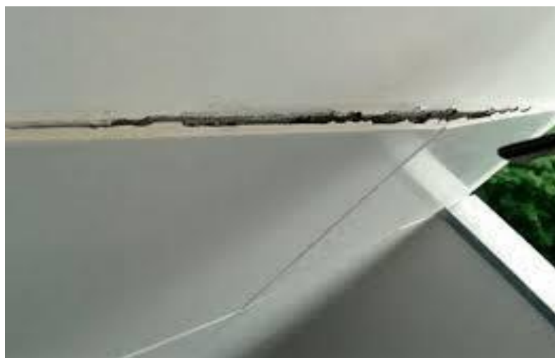
FIGURA 2: Representação do deslocamento em revestimento cerâmico FONTE: RESMASTER ENGENHARIA (2018)
