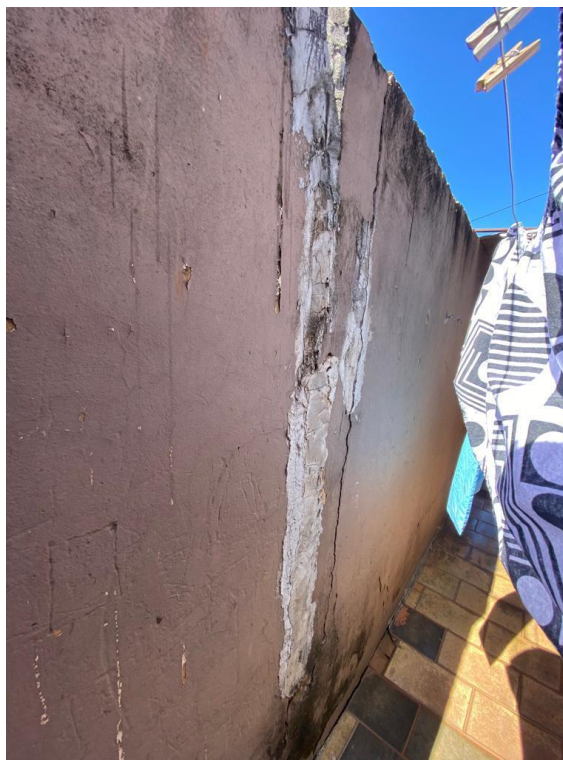
Figura 29: MP 09 - Lavanderia com infiltração Fonte: Próprio Autor, (2023)
