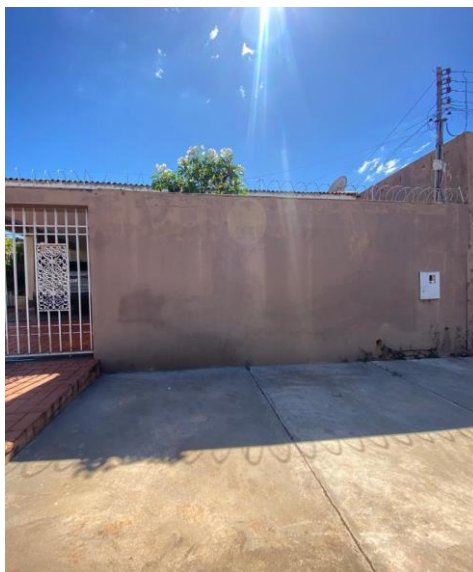
Figura 39: MP 17 - Fachada com infiltração Fonte: Próprio Autor, (2023).
