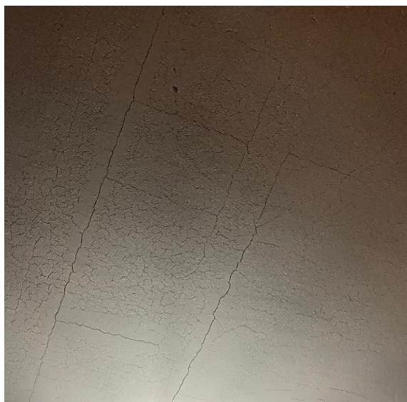
Figura 21: MP 01 - Laje da suíte com fissuras mapeadas Fonte: Próprio Autor, (2023)
