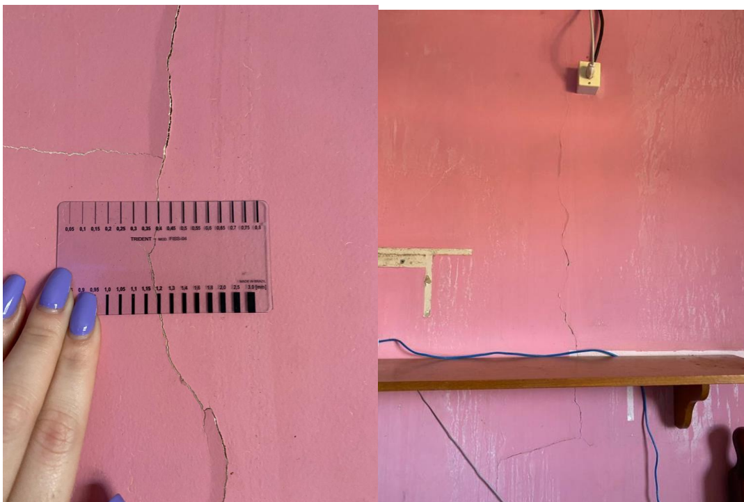
Figura 24: MP 04 – Parede quarto 01 Fonte: Próprio Autor, (2023).
