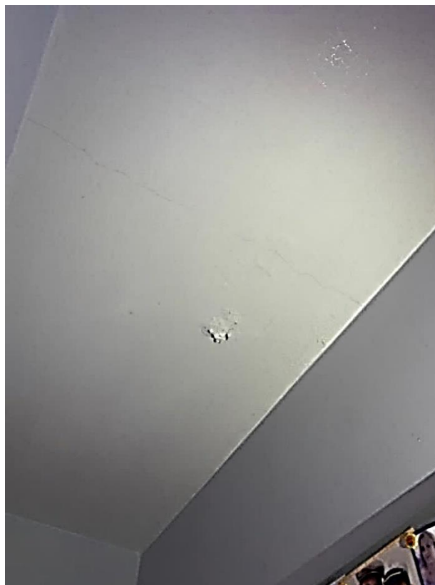
Figura 22: MP 02 - Laje do corredor com fissuras e bolhas Fonte: Próprio Autor, (2023).
