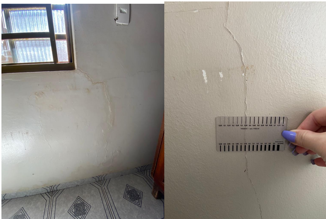
Figura 28: MP 08 -Fissura quarto 02 Fonte: Próprio Autor, (2023).
