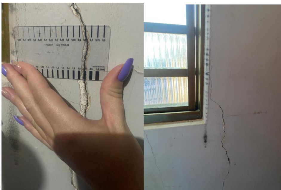
Figura 27: MP 07 - Rachadura do quarto 01. Fonte: Próprio Autor, (2023).
