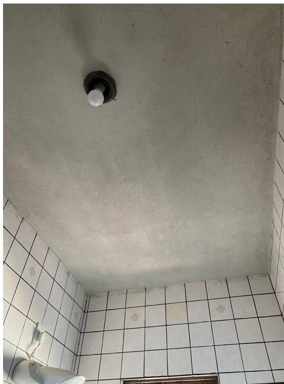
Figura 23: MP 03 - Laje do banheiro-01 com fissuras Fonte: Próprio Autor, (2023).
