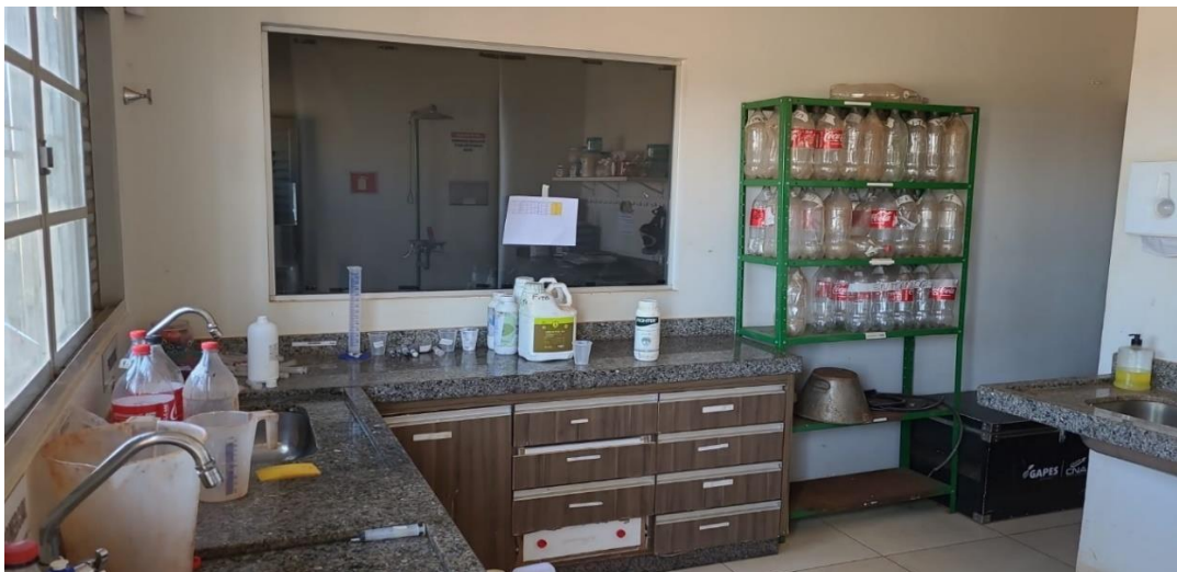
Figura 4. Sala de dosagem dos produtos.
