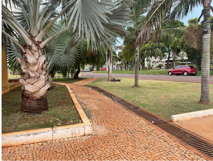
Figura 14: Condições da calçada de acesso à biblioteca e grades de drenagem que dificultam a passagem da cadeira de rodas no IF Goiano. Fonte: Autoria própria (2023).
