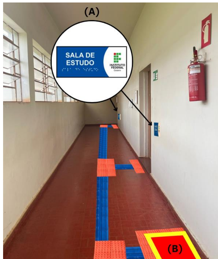
Figura 25: (a) Placa no acesso a sala de estudo (b) Piso tátil para indicação de localização do extintor de incêndio
