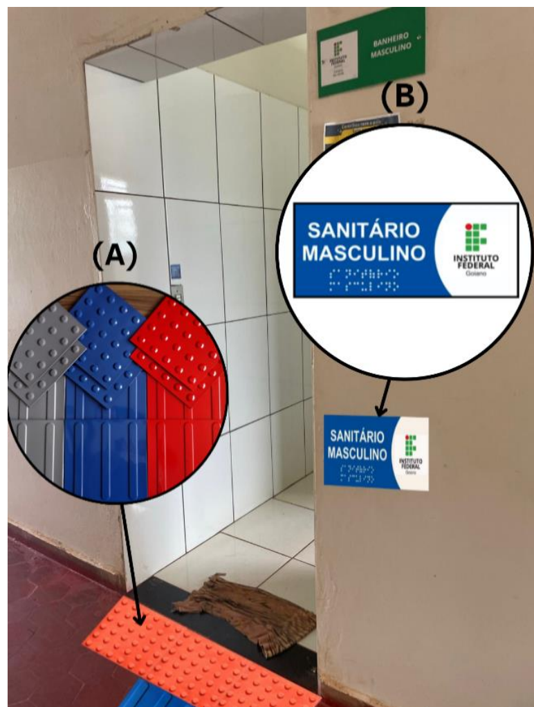
Figura 23: (a) Simulação de piso tátil e (b) Placa no acesso ao banheiro. Fonte: Autoria própria (2023).
