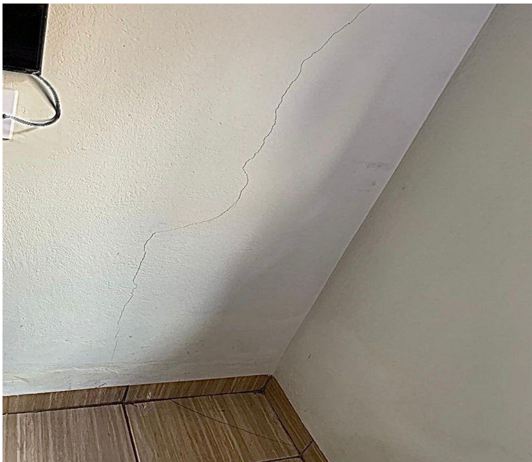
Figura 20 - Fissura vertical na parede do quarto 3
