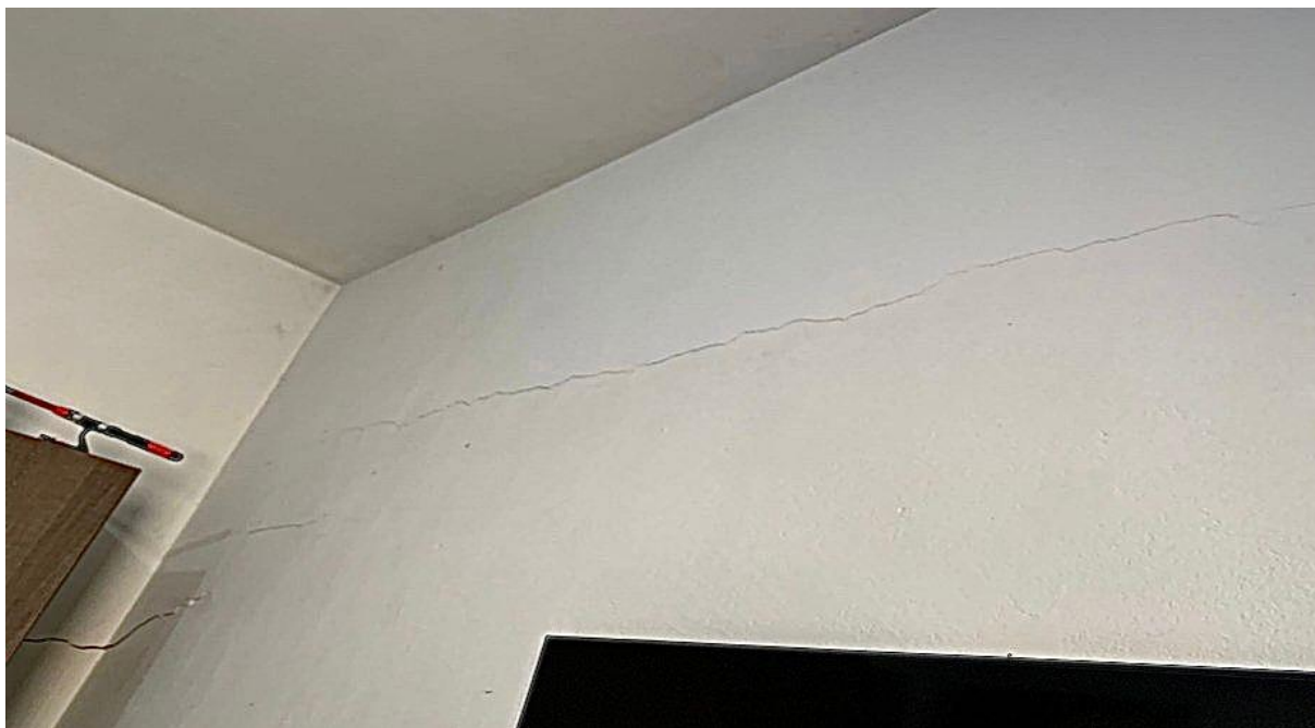
Figura 19 - Fissuras horizontais na parede do quarto 3
