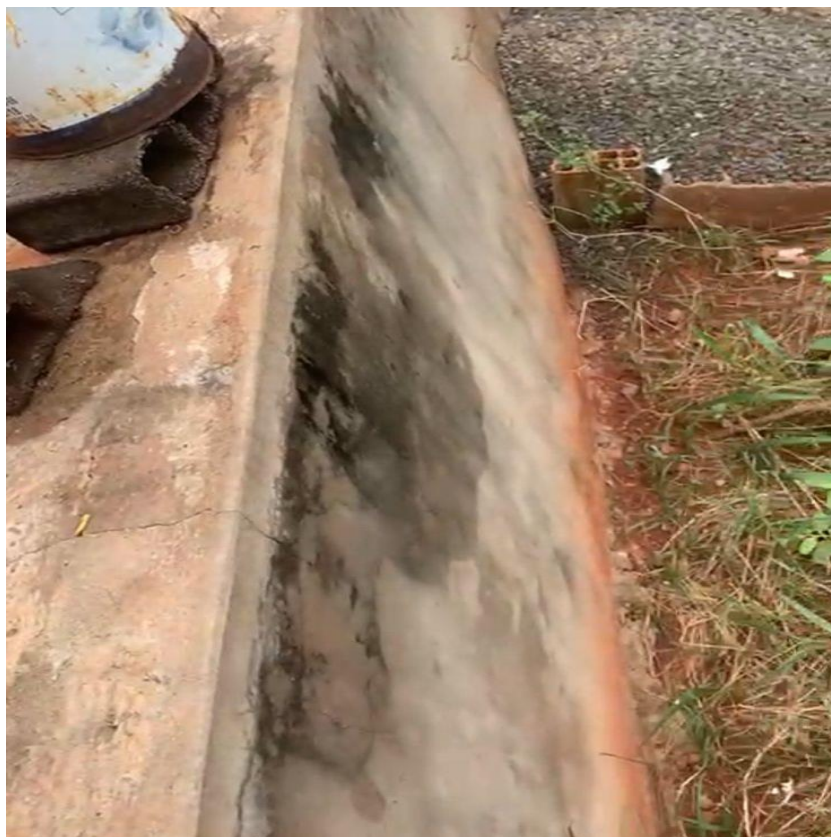
Figura 17 - Manifestações patológicas no muro de arrimo
