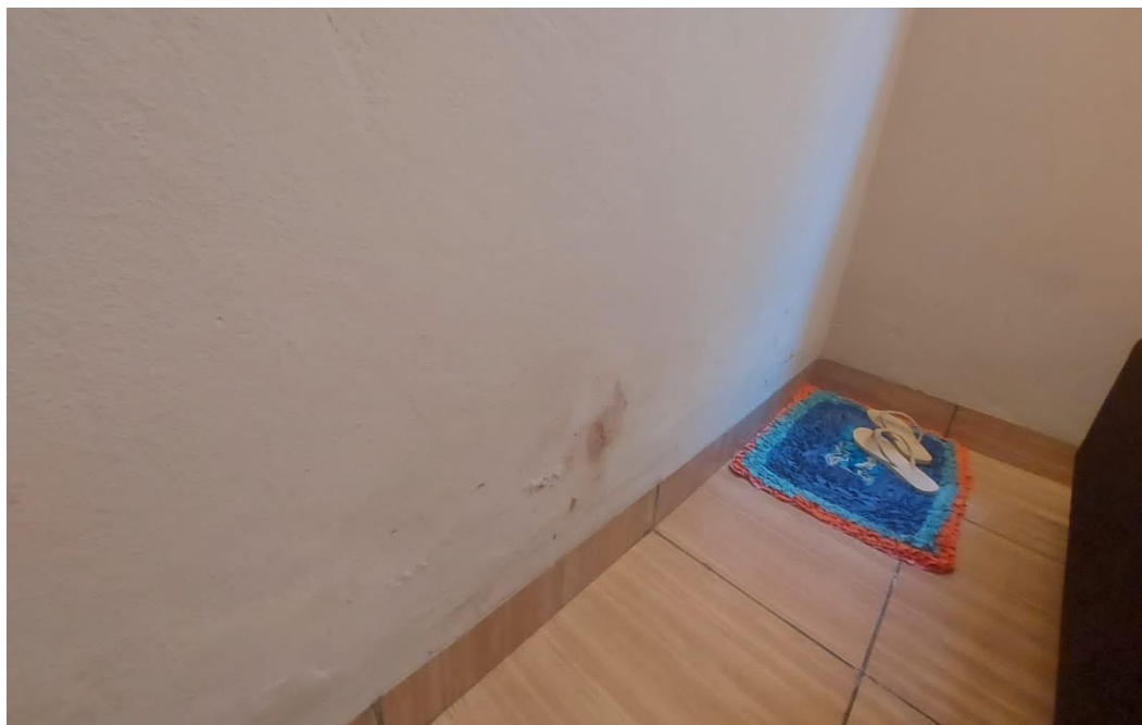
Figura 27 - Umidade na parte inferior da parede do quarto 1
