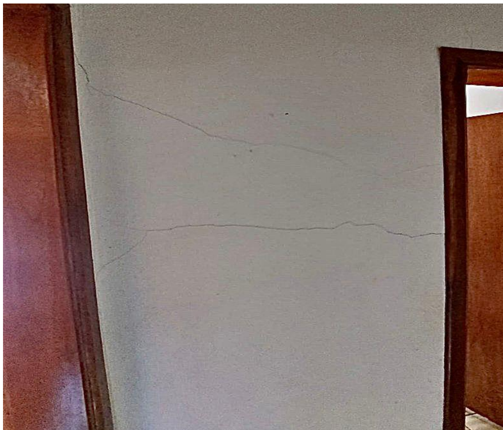
Figura 26 - Fissuras na parede divisa do hall com o banheiro
