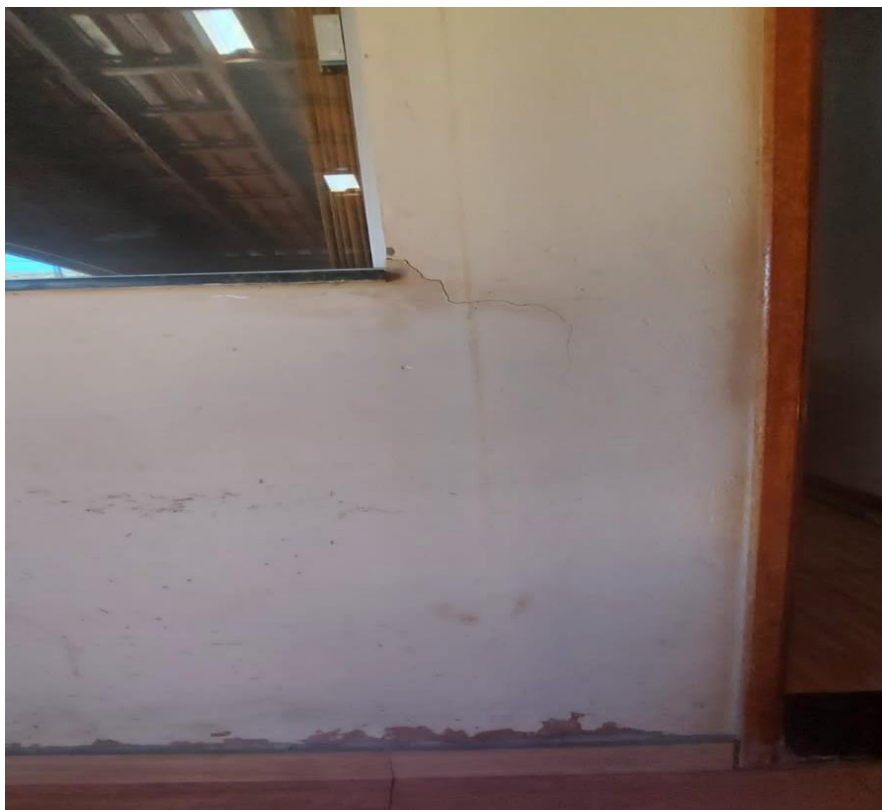
Figura 15 - Fissura diagonal da janela da sala
