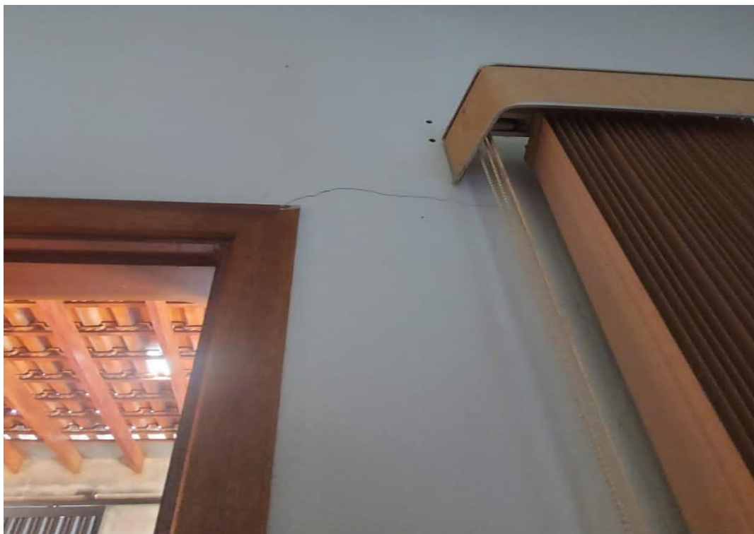
Figura 16 - Fissura diagonal da porta da sala
