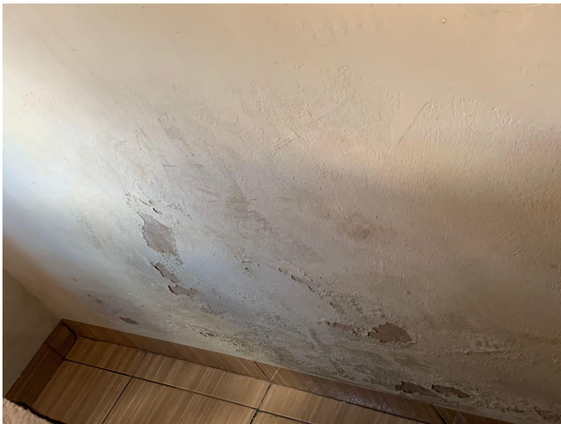
Figura 18 - Parede de divisa entre quarto 3 e o banheiro
