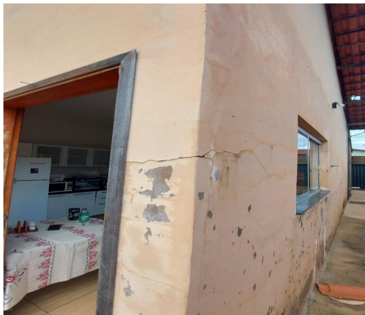
Figura 28 - Fissura diagonal externo cozinha
