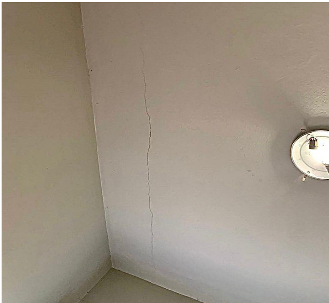
Figura 25 - Fissura horizontal laje do quarto 2
