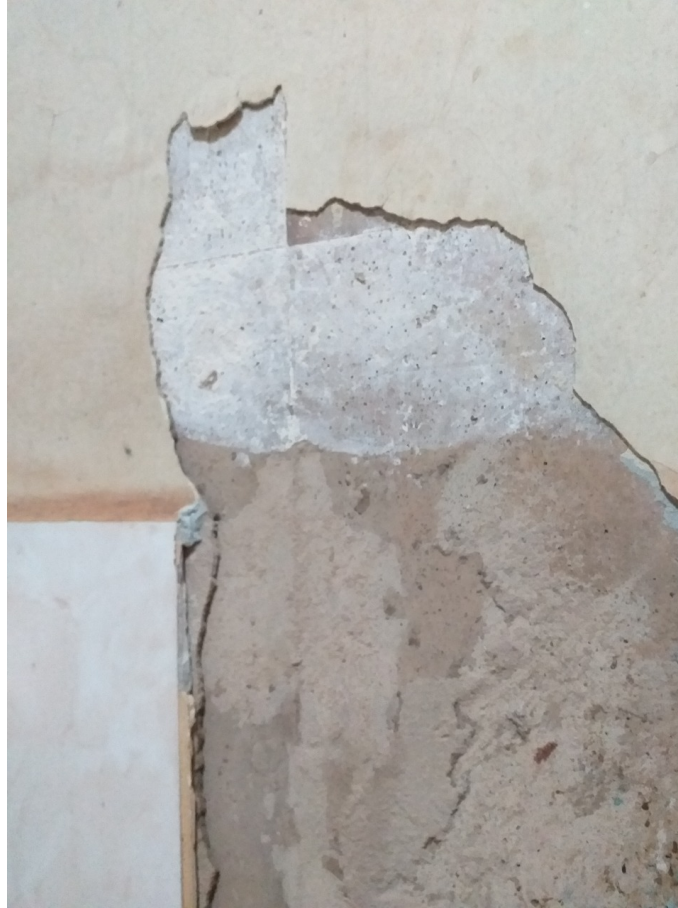
Figura 18 – Descascamento da parede interna.
