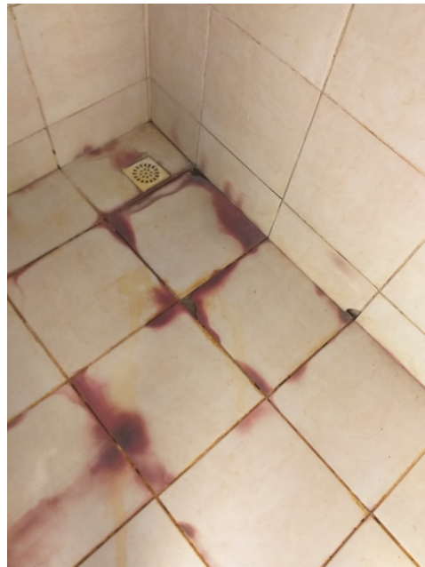
Figura 29 – Infiltração no piso do banheiro.
