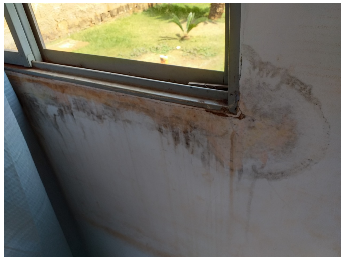
Figura 27 – Infiltração na base da janela.
