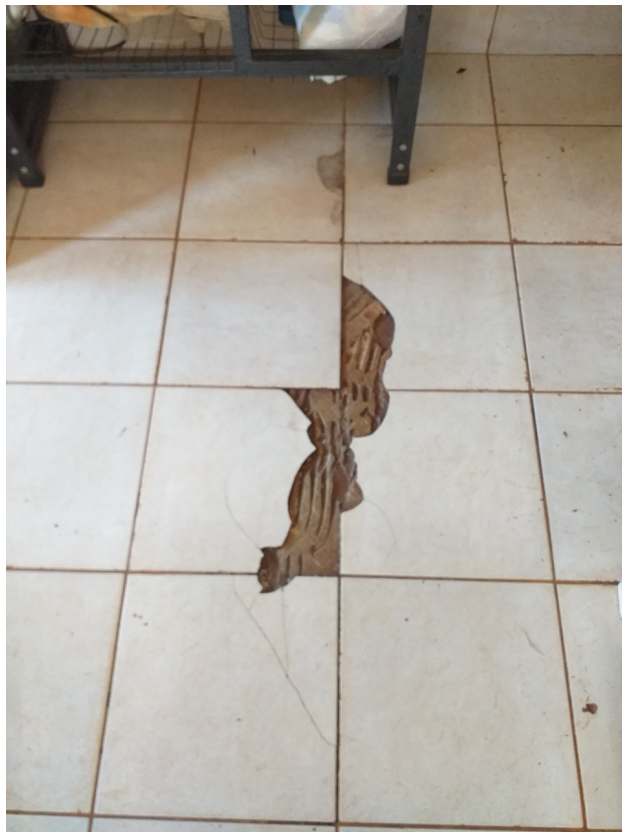
Figura 22 – Trinca e descolamento de cerâmica.
