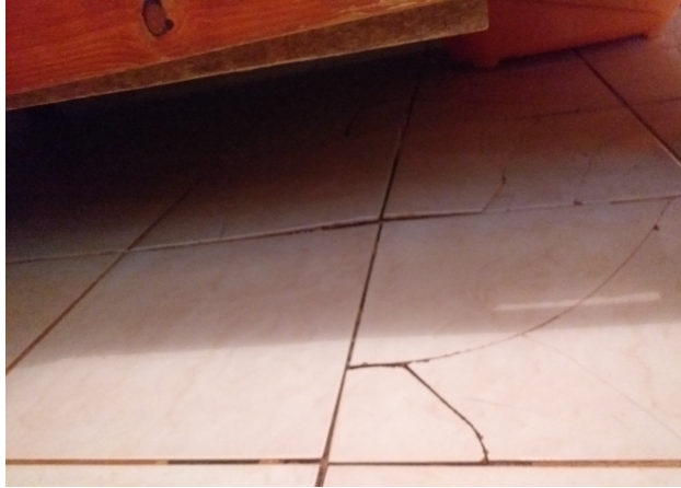
Figura 21 – Trinca na cerâmica interna.
