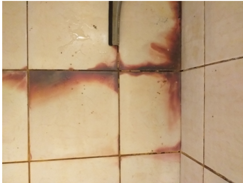
Figura 28 – Infiltração piso cerâmico.
