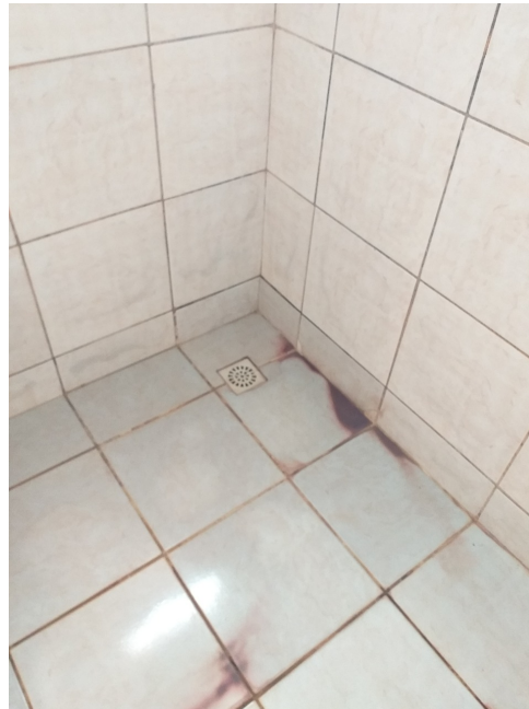
Figura 30 – Infiltração no piso do banheiro.
