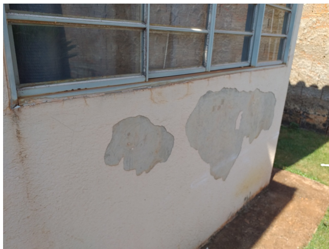
Figura 17 – Descascamento parede externa.
