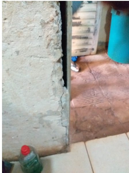
Figura 20 – Descascamento de alvenaria.
