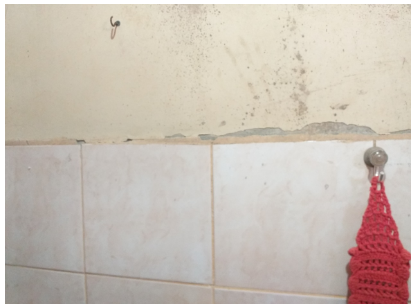
Figura 19 – Descascamento da parede do banheiro.
