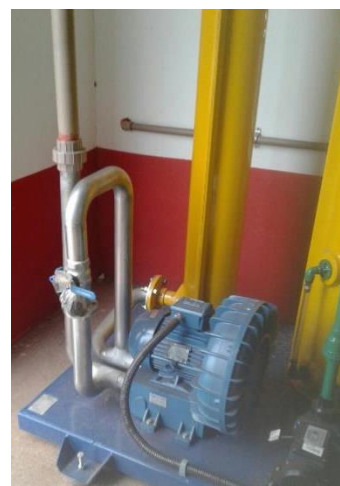
(b) chegada do biogás
