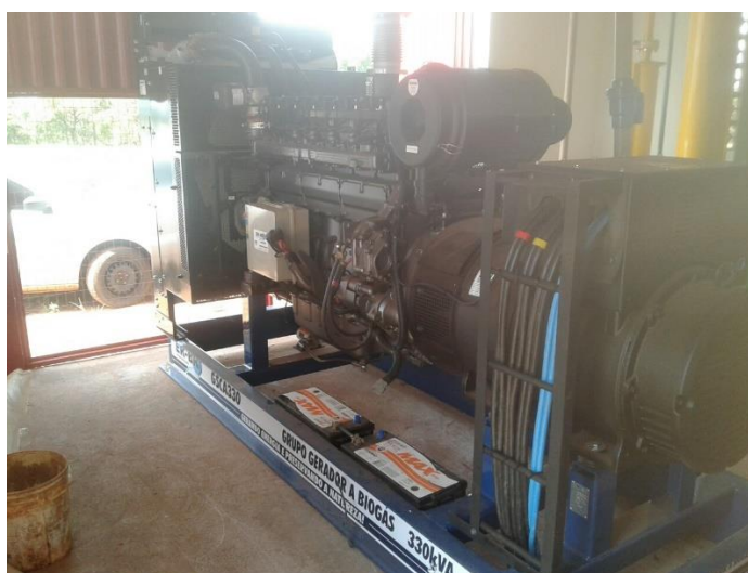
Figura 13. Gerador a biogás da Granja B
