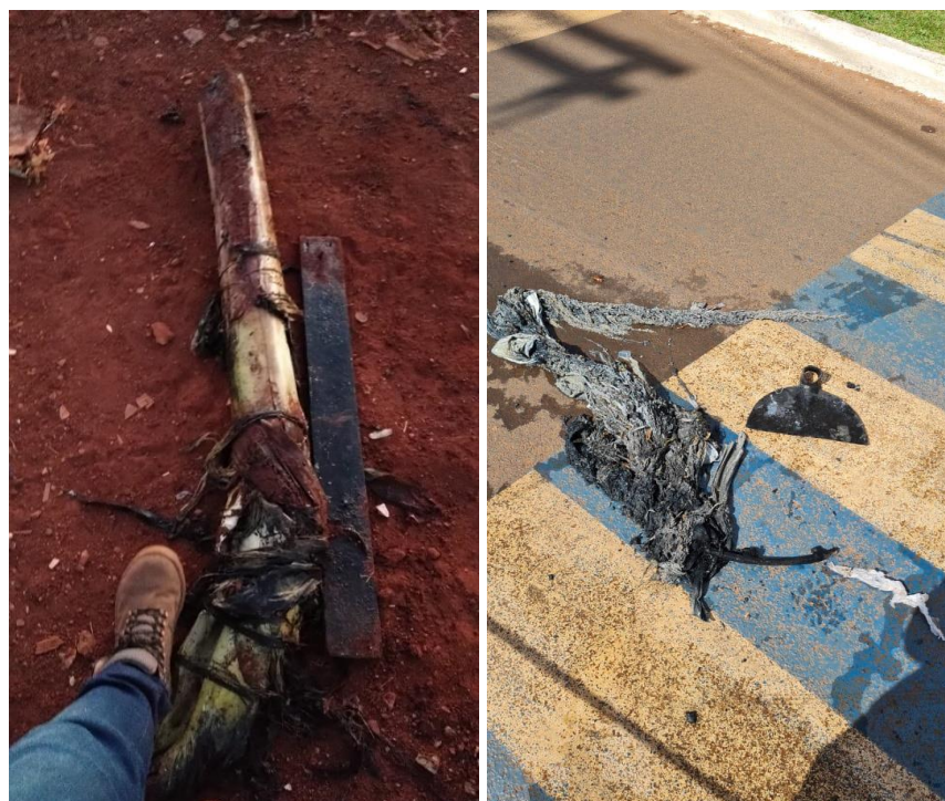
Figura 20 – bananeira e resíduos sólidos encontrados na rede de esgoto. Fonte: dados internos – BRK Ambiental (2022)
