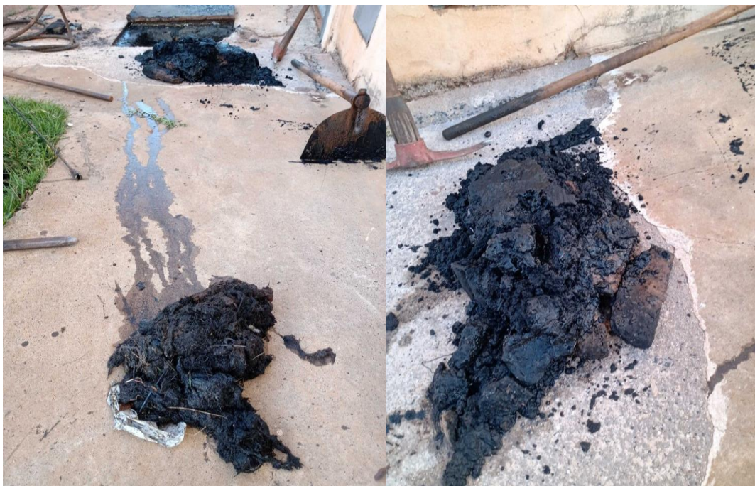
Figura 18 – Bucha, resíduos sólidos e gordura encontrados na rede de esgoto. Fonte: dados internos – BRK Ambiental (2022).
