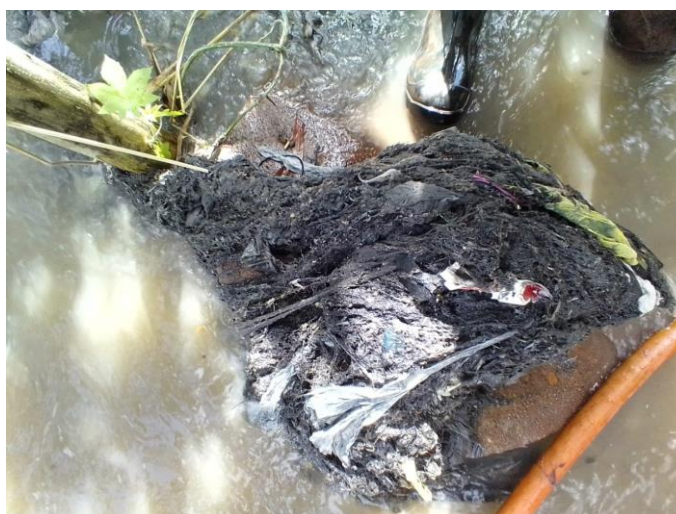
Figura 19 – Bucha, resíduos sólidos encontrados na rede de esgoto. Fonte: dados internos – BRK Ambiental (2022).
