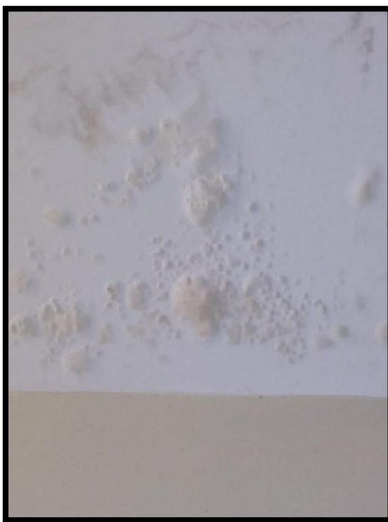
Figura 33: Saponificação e bolhas na pintura no banheiro masculino 1° andar do bloco administrativo
