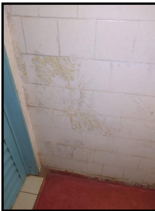
Anexo 16: Descascamento da pintura da parede da sala do patrimônio da instituição na ala oeste do bloco administrativo
