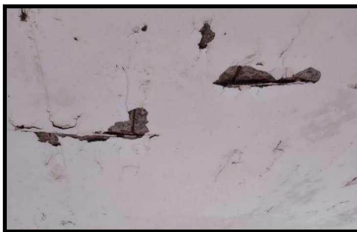
Figura 6: Armadura exposta oxidada na passarela na ala sul do bloco administrativo
