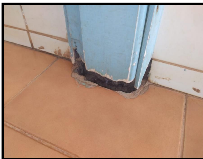
Figura 48: Deterioração da porta do banheiro feminino da ala oeste do térreo do bloco administrativo
