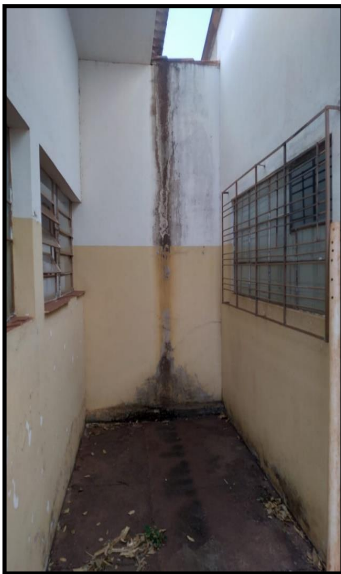
Figura 20: Machas de mofo e fungos na parede da ala oeste ao lado da sala 01 do bloco administrativo
