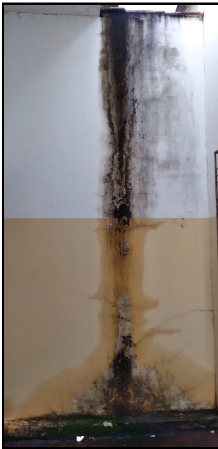
Figura 22: Machas de mofo e fungos na parede da ala oeste ao lado da sala 01 do bloco administrativo
