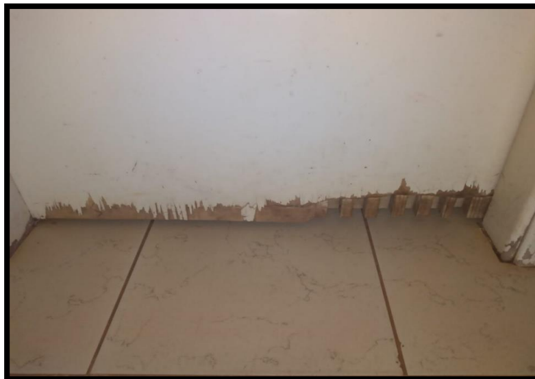
Figura 50: Deterioração da porta do banheiro masculino do piso 1° andar do bloco administrativo
