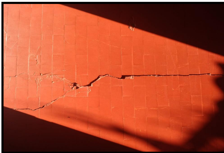
Anexo 7: Rachadura no piso da sala de edificações na ala oeste do bloco administrativo
