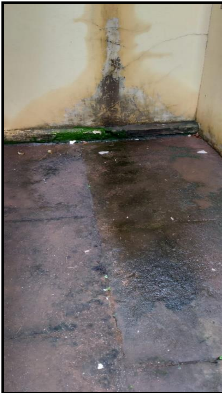
Figura 21: Machas de mofo e fungos na parede da ala oeste ao lado da sala 01 do bloco administrativo
