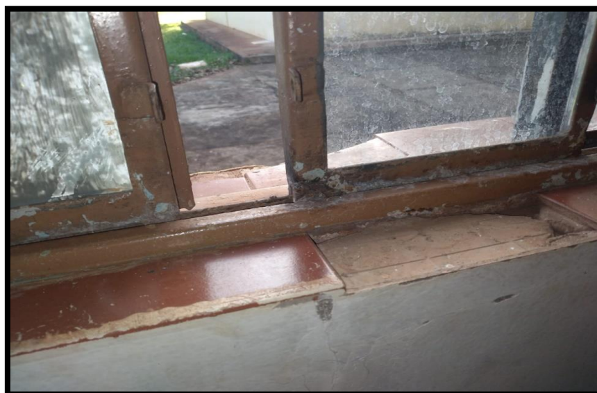
Figura 57: Azulejos deteriorado nas janelas da sala 01
