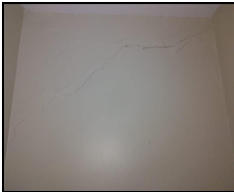
Figura 17: Fissura no auditório do primeiro andar do bloco administrativo
