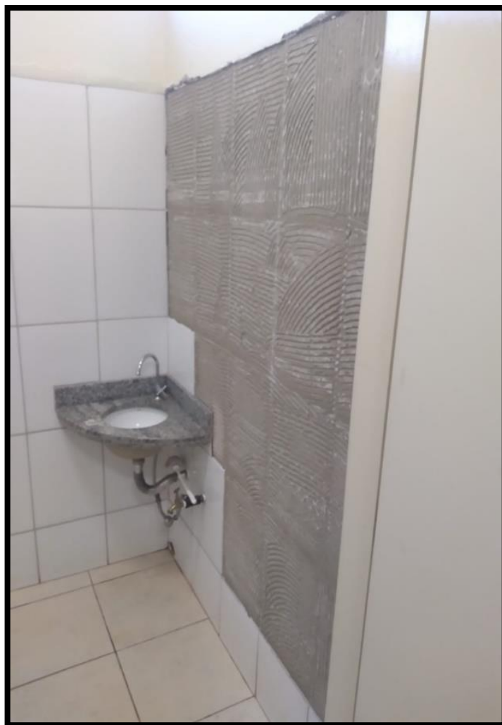
Figura 53: Desplacamento de azulejos no banheiro feminino do piso 1º andar do bloco administrativo
