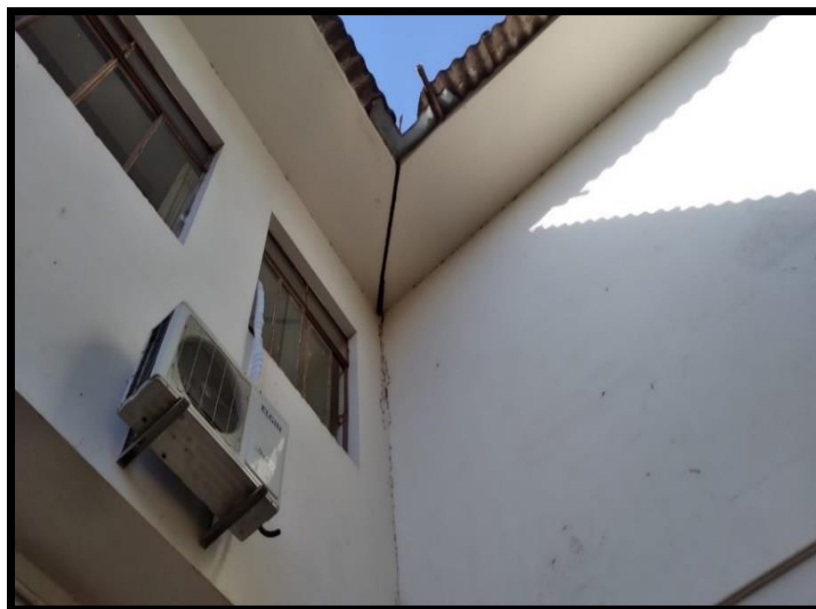
Figura 11: Rachadura acima do hall de entrada na ala oeste do bloco administrativo
