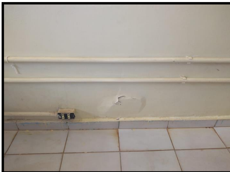
Anexo 19: Bolha na pintura da sala de arquivos da secretaria de graduação de cursos técnicos do bloco pedagógico I
