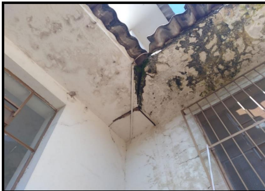
Figura 12: Rachadura acima da administração da cozinha da ala oeste do bloco administrativo
