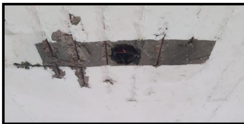
Figura 7: Armadura exposta oxidada na passarela na ala norte do bloco administrativo
