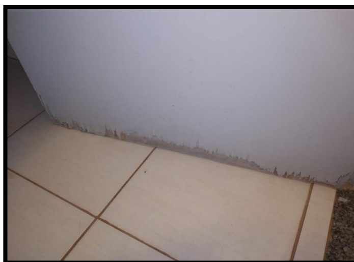
Anexo 24: Deterioração da porta do banheiro masculino da secretaria de graduação de cursos técnicos do bloco pedagógico I
