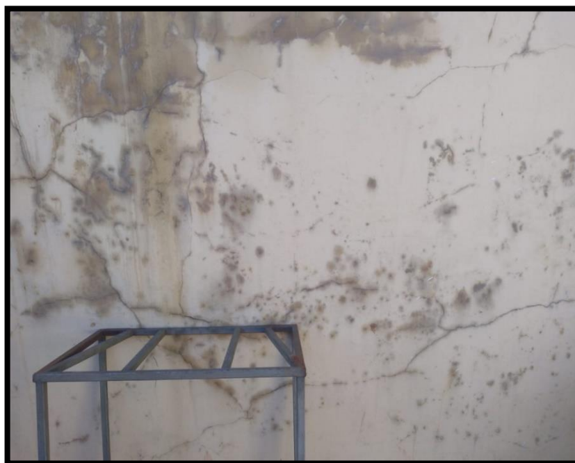
Figura 37: Manchas na pintura na parede da sala do patrimônio do bloco administrativo
