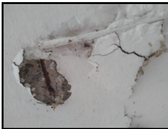
Figura 5: Armadura exposta oxidada na passarela na ala sul do bloco administrativo
