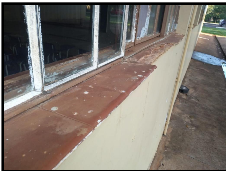
Figura 55: Azulejos deteriorado nas janelas da sala 01
