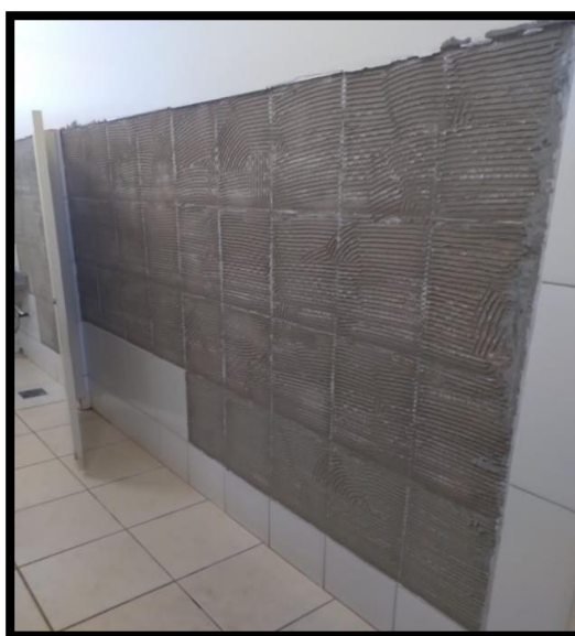
Figura 52: Deslocamento de azulejos no banheiro feminino do piso 1º andar do bloco administrativo
