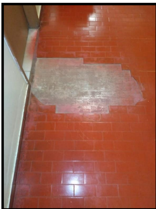
Anexo 26: Desplacamento do piso do corredor da secretaria de graduação de cursos técnicos do bloco pedagógico I
