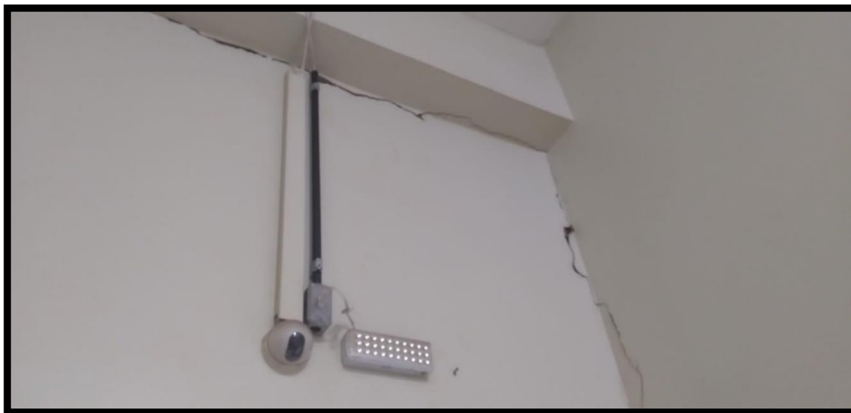
Anexo 5: Fissura no corredor das salas administrativas da instituição no primeiro andar no bloco administrativo
