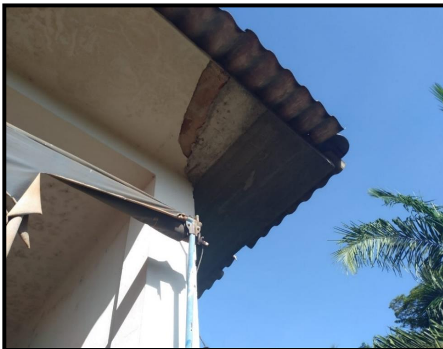
Figura 14: Rachadura acima da varanda da ala oeste do bloco administrativo
