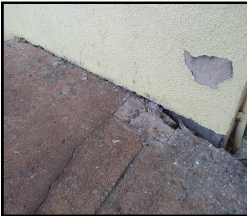
Figura 10: Rachadura na ala leste do bloco administrativo
