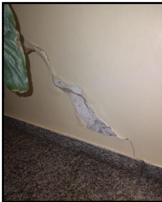
Figura 36: Descascamento da pintura e fissura nas escadarias do bloco administrativo
