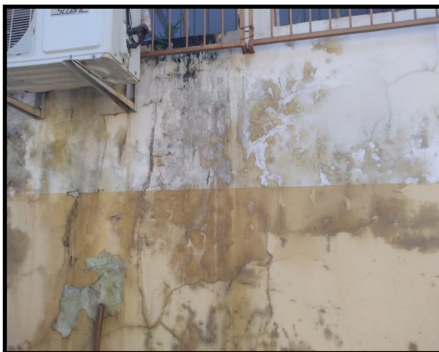
Figura 38: Manchas na pintura na parede da sala do patrimônio do bloco administrativo
