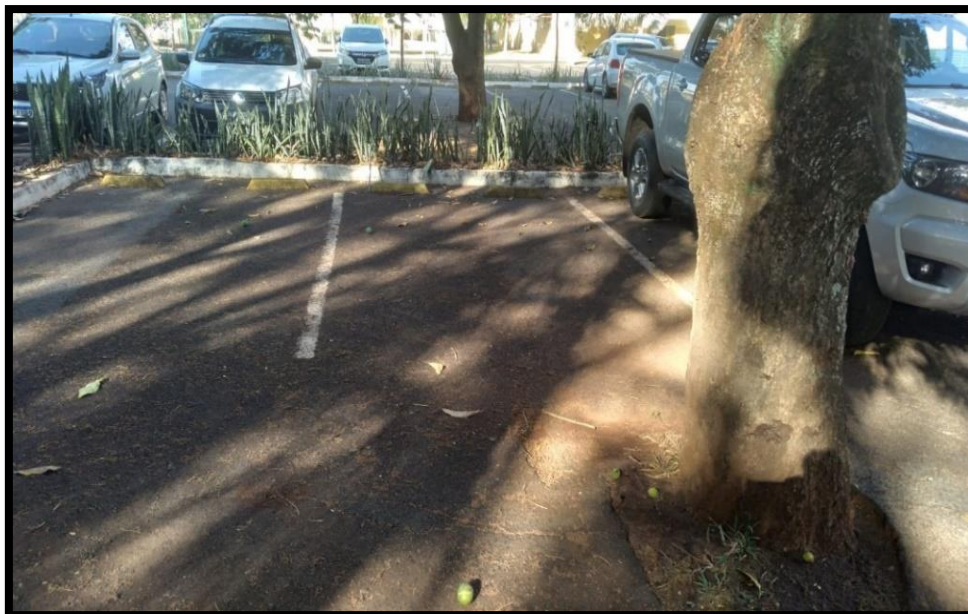
Figura 60: Presença de árvore como uma manifestação patológica no local
