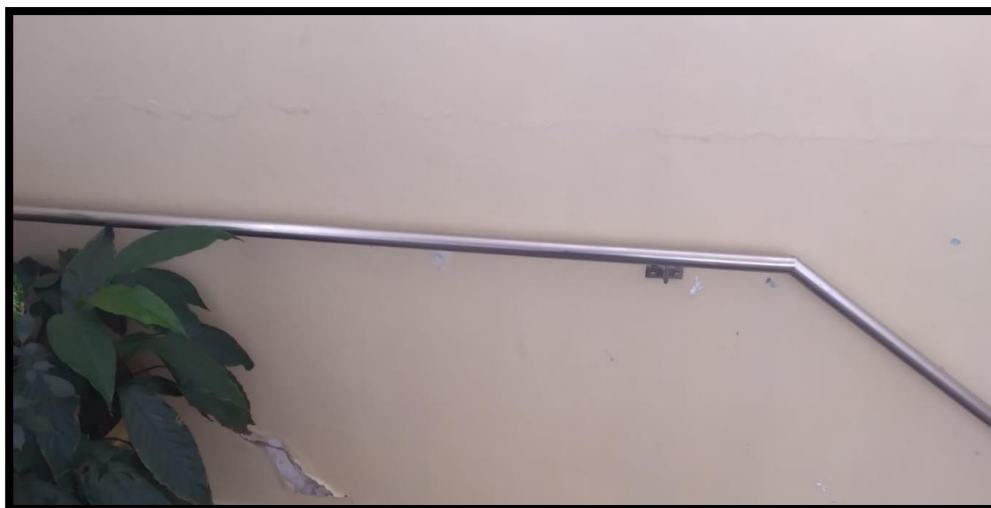
Anexo 3: Descascamento da pintura e trincas na parte inferior da escadaria do bloco administrativo
