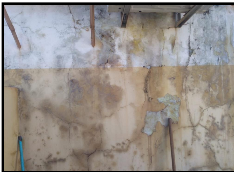
Figura 39: Manchas na pintura na parede da sala do patrimônio do bloco administrativo
