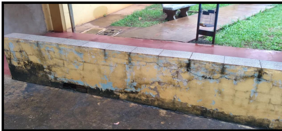
Anexo 15: Bolor e descascamento na alvenaria de vedação na passarela da ala sul do bloco administrativo
