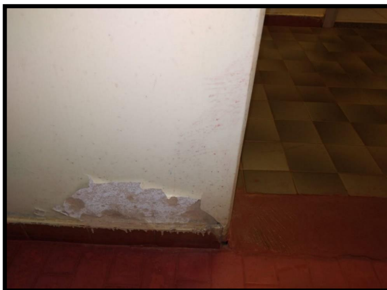
Anexo 20: Descascamento da pintura do corredor da secretaria de graduação de cursos técnicos do bloco pedagógico I
