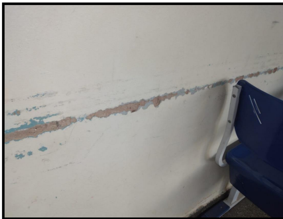
Figura 41: Descascamento da pintura na sala 05 do bloco pedagógico 01
