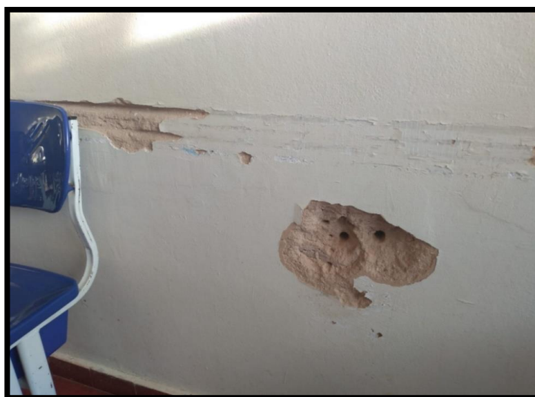
Anexo 18: Deterioração da alvenaria da sala 12 na ala leste do bloco pedagógico I
