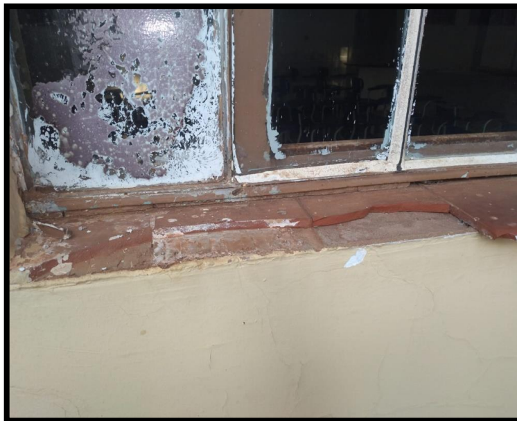
Figura 54: Azulejos deteriorado nas janelas da sala 01
