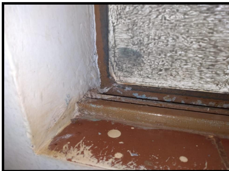
Anexo 21: Oxidação da janela da sala 02 na ala oeste do bloco pedagógico I
