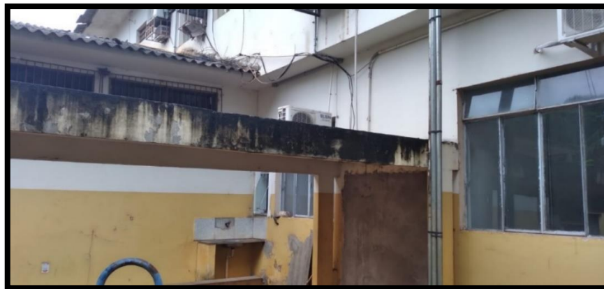
Figura 32: Manchas de mofo e fungos na passarela da ala sul do bloco administrativo
