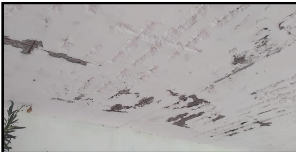
Anexo 1: Armadura exposta oxidada na passarela na ala sul do bloco administrativo
