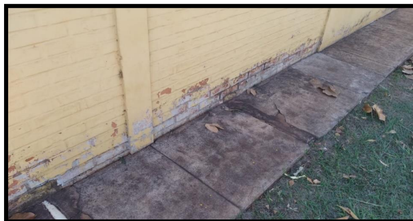
Figura 28: Manchas de mofo e fungos na varanda da ala oeste do bloco administrativo
