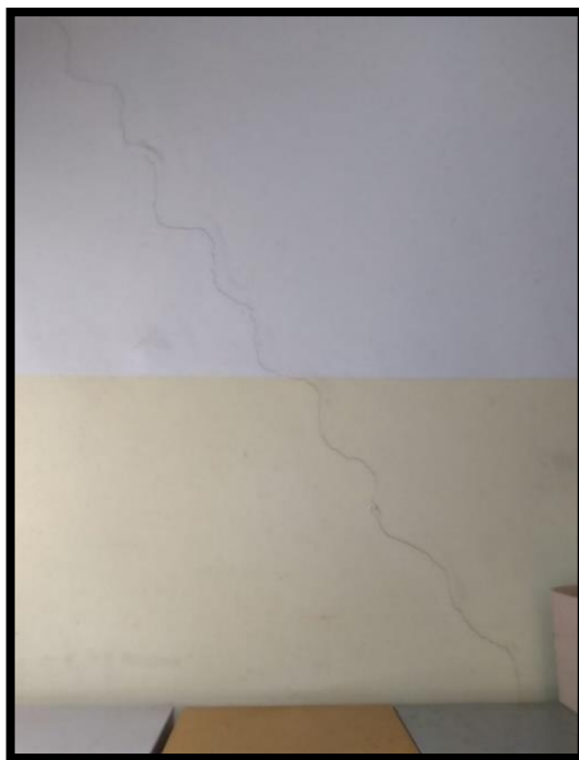
Figura 18:Fissura acima de uma porta na secretaria de graduação de cursos técnicos do bloco pedagógico
