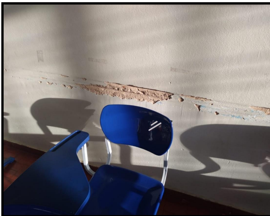
Figura 43: Descascamento da pintura na sala 06 do bloco pedagógico 01
