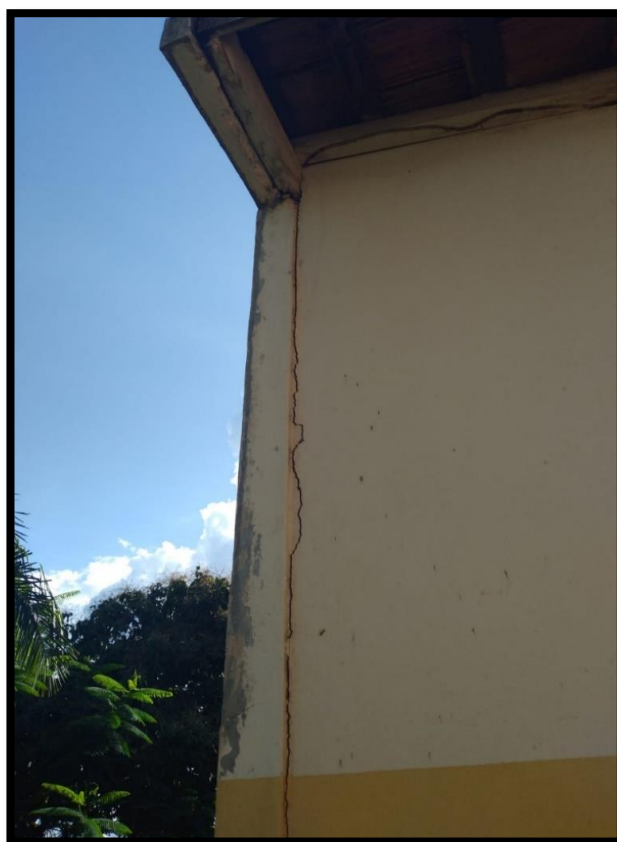
Anexo 2: Trincas na parte externa da varanda da ala oeste do bloco administrativo
