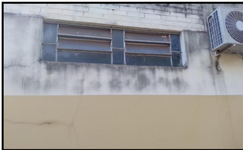
Figura 26: Manchas de mofo e fungos na varanda da ala oeste do bloco administrativo
