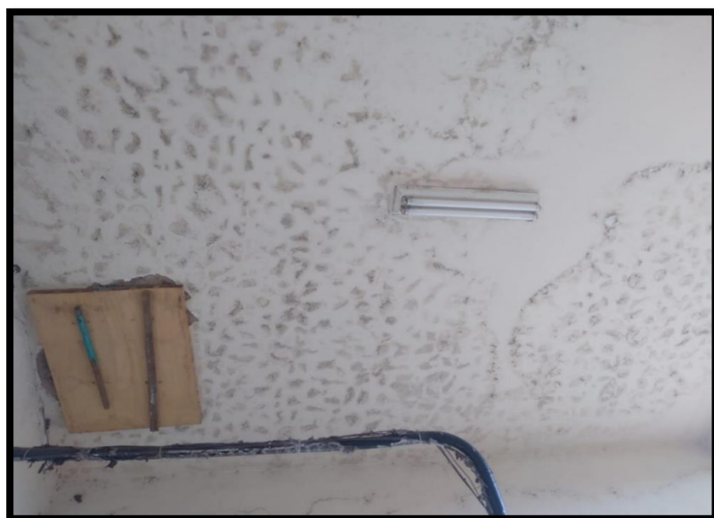
Figura 40: Manchas na pintura no teto do banheiro feminino da ala oeste do térreo do bloco administrativo
