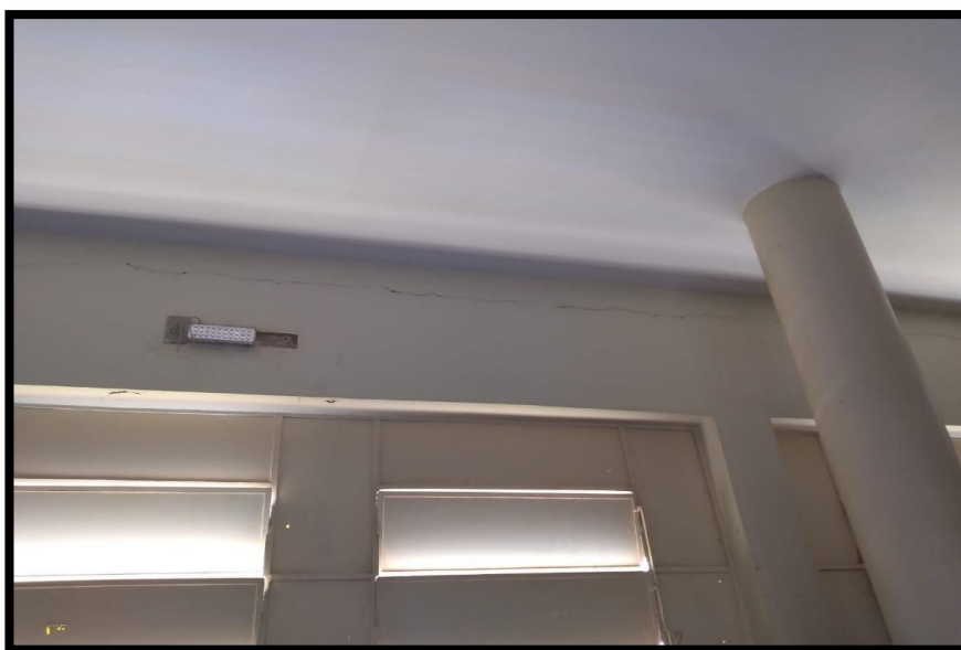
Anexo 6: Rachadura no auditório do primeiro andar do bloco administrativo
