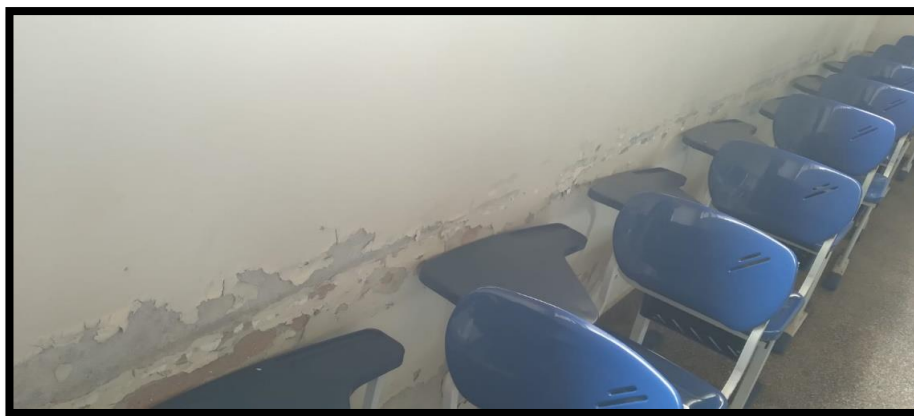
Figura 44: Descascamento da pintura na sala 08 do bloco pedagógico 01
