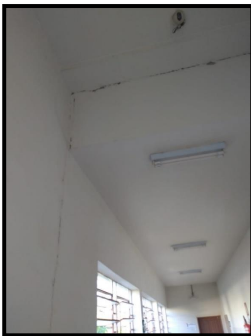
Anexo 10: Fissura no corredor da ala leste do bloco pedagógico I
