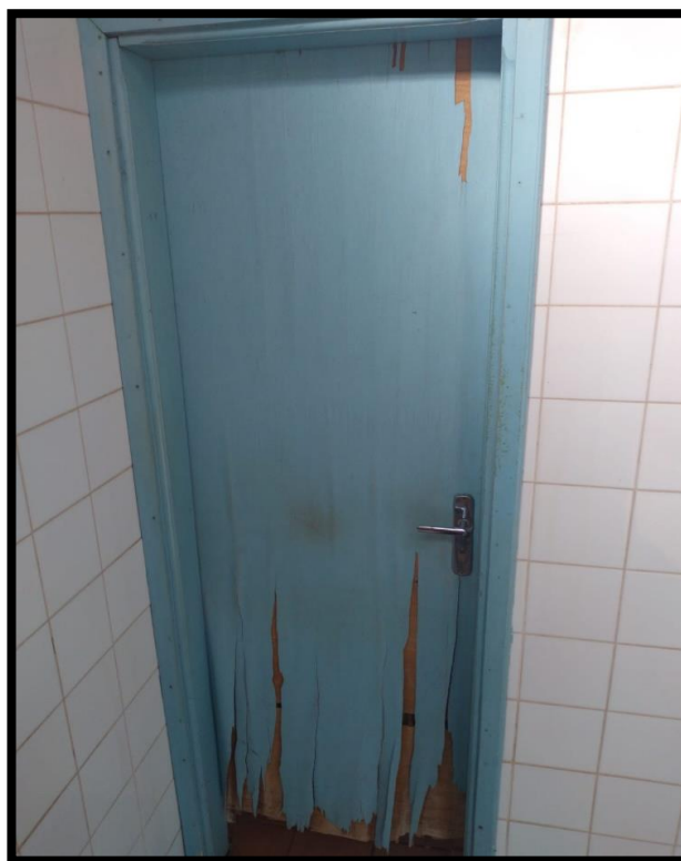
Figura 49: Deterioração da porta do banheiro feminino da ala oeste do térreo do bloco administrativo
