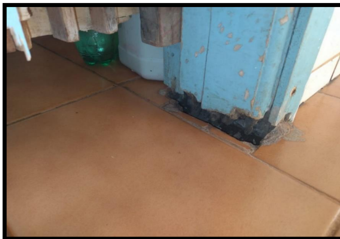
Figura 47: Deterioração da porta do banheiro feminino da ala oeste do térreo do bloco administrativo
