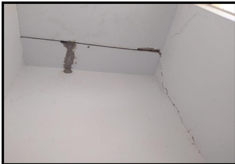
Anexo 13: Trinca no teto do banheiro do patrimônio da instituição na ala oeste do bloco administrativo
