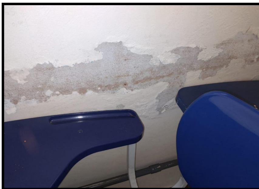
Figura 42: Descascamento da pintura na sala 08 do bloco pedagógico 01
