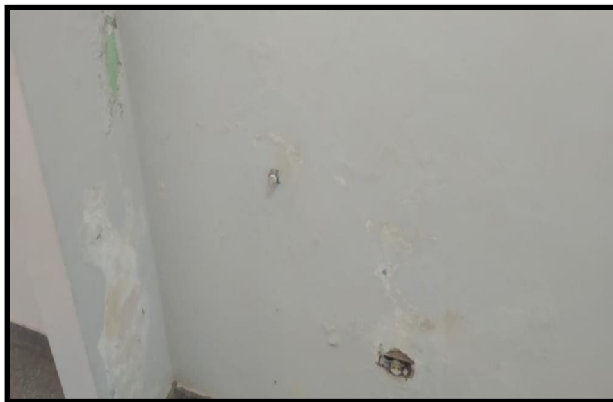
Figura 35: Descascamento da pintura em frente do laboratório de informática 03 do bloco pedagógico I
