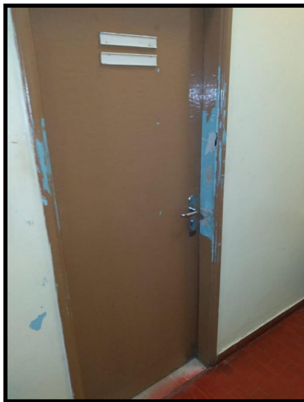
Anexo 23: Deterioração da pintura da sala de arquivos da secretaria de graduação de cursos técnicos do bloco pedagógico I
