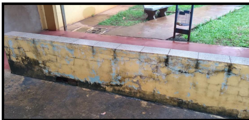
Figura 30: Manchas de mofo e fungos na passarela da ala sul do bloco administrativo
