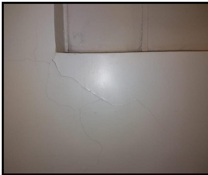
Figura 15: Fissura no auditório do primeiro andar do bloco administrativo
