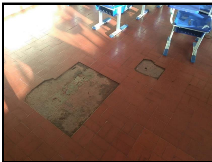
Figura 59: Desplacamento de azulejos na sala 12 do bloco pedagógico I
