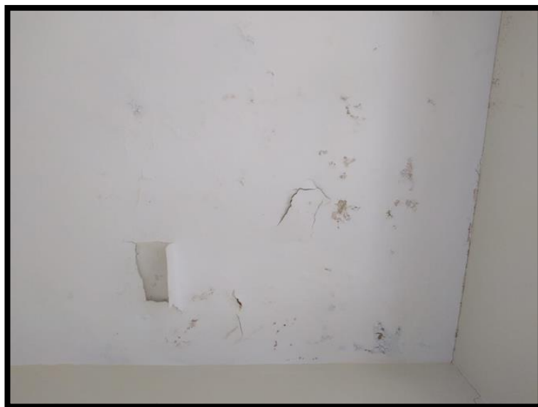
Anexo 17: Descascamento da pintura do teto administrativo
