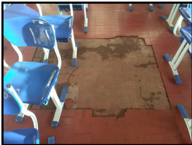
Figura 58: Desplacamento de azulejos na sala 11 do bloco pedagógico I
