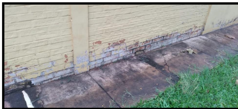
Figura 29: Manchas de mofo e fungos na varanda da ala oeste do bloco administrativo
