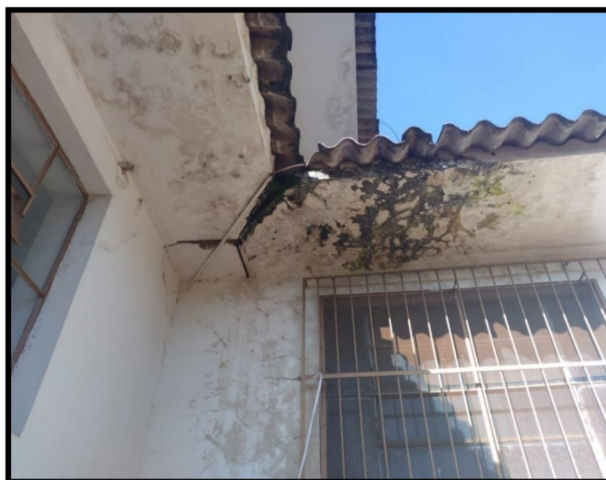
Figura 13: Rachadura acima da administração da cozinha da ala oeste do bloco administrativo
