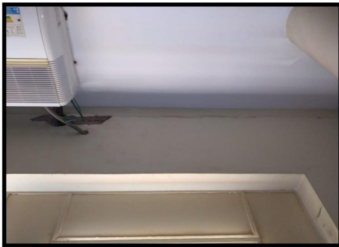
Anexo 9: Fissura no auditório do primeiro andar do bloco administrativo
