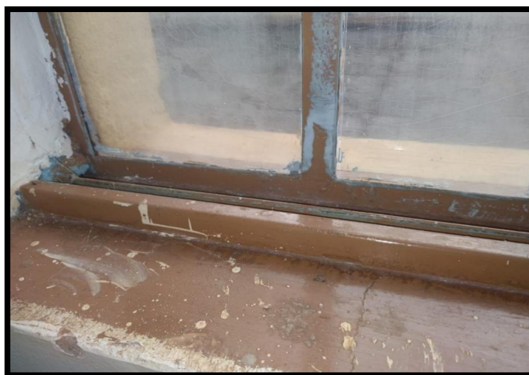
Anexo 22: Oxidação da janela da sala 01 na ala oeste do bloco pedagógico I
