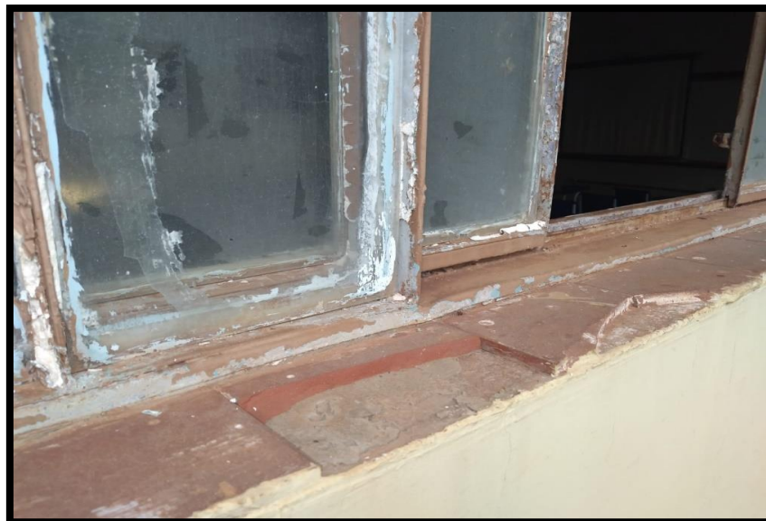
Figura 56: Azulejos deteriorado nas janelas da sala 01
