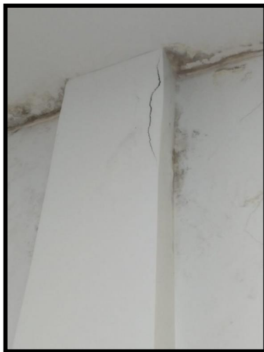
Anexo 11: Fissuras na sala de arquivos da secretaria de graduação de cursos superiores do bloco pedagógico I
