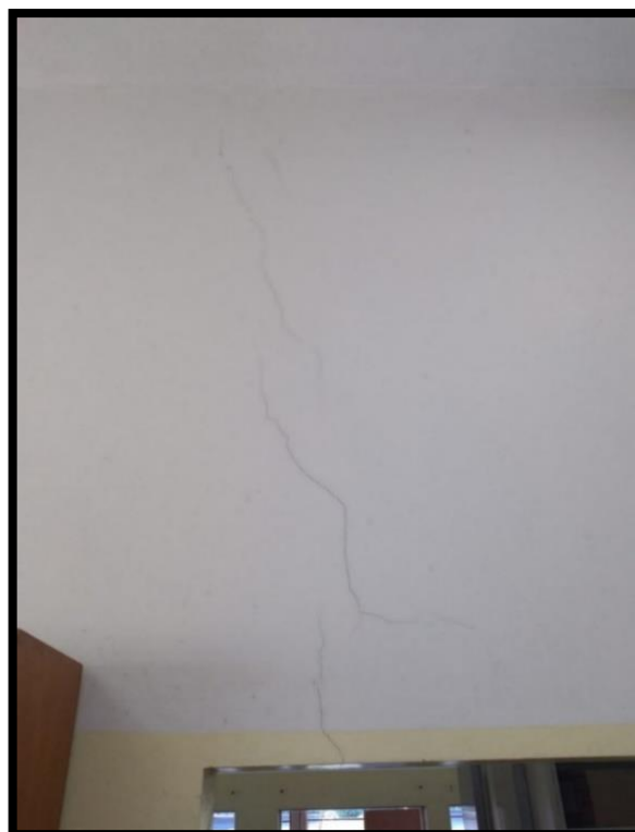
Figura 19: Fissura acima de uma porta na secretaria de graduação de cursos técnicos do bloco pedagógico
