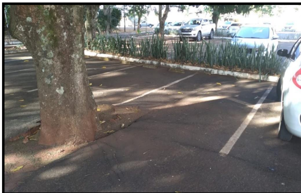
Figura 61: Presença de árvore no estacionamento do bloco administrativo
