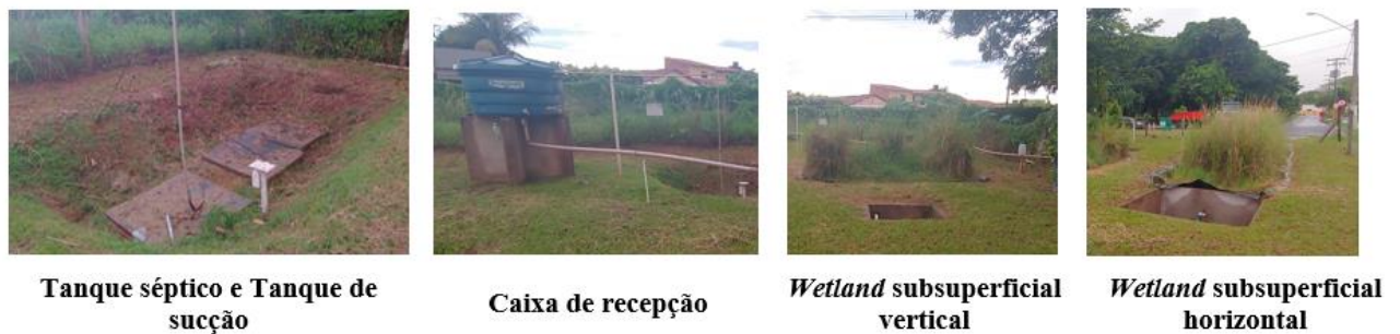
Figura 16. Estação de tratamento de esgoto real.
