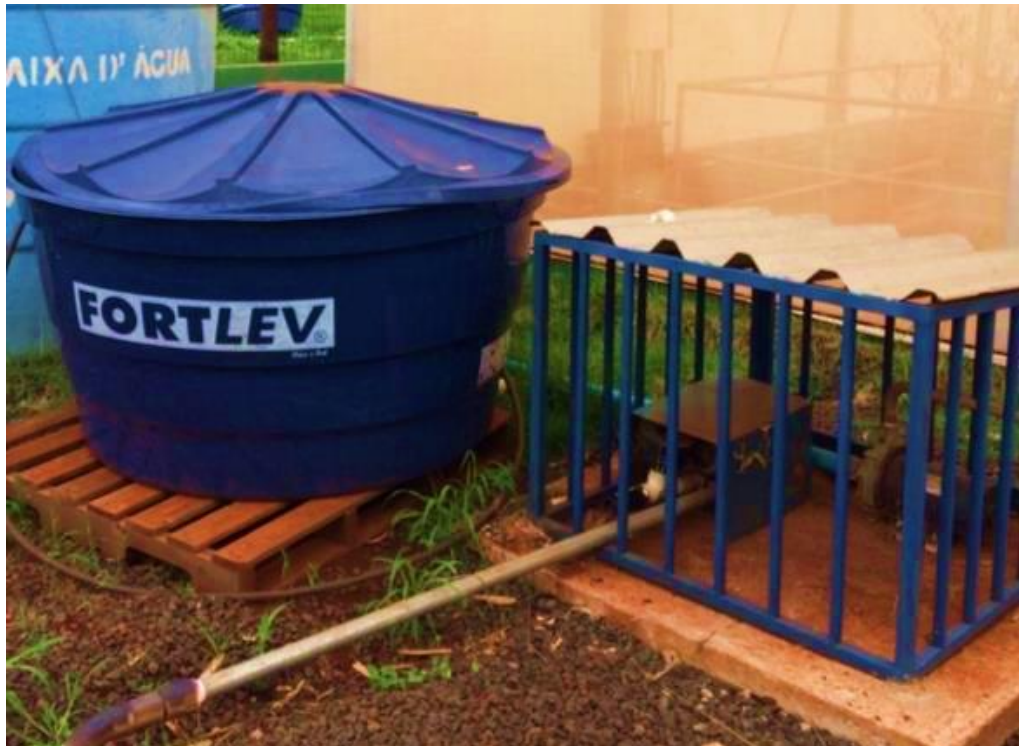
Figura 7. Local de instalação da bomba de ar.
