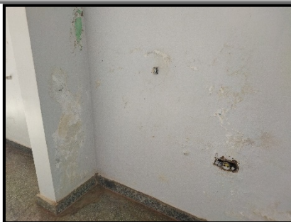
FIGURA 2 F – INFILTRAÇÃO E INSTALAÇÃO ANTIGA . FONTE: A AUTORA
