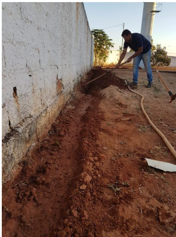
Figura 14. Instalação da tubulação de PVC para o sistema de irrigação do projeto de extensão: “Irrigação automática e econômica em uma horta escolar no município de Urutaí – GO”. Autoria própria (2018).
