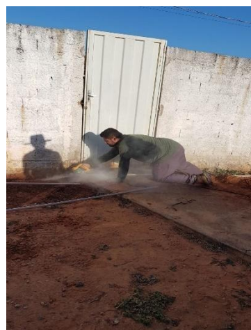
Figura 4. Instalação das linhas de distribuição do sistema de irrigação, por tubulação de polietileno de 16 mm de diâmetro. Autoria própria (2018).
