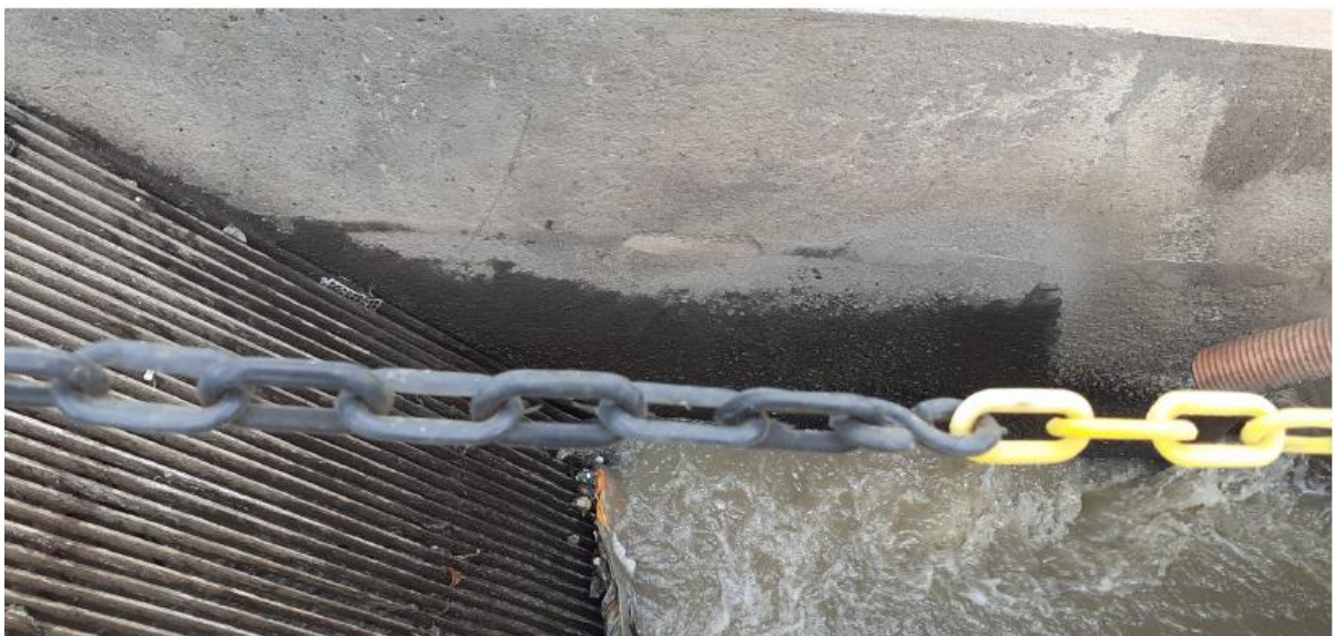
Figura 19: Detalhe do gradeamento do tratamento preliminar Fonte: AMAE (2020).
