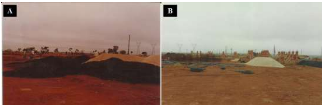
Figura 2. A e B. Início das construções da UNED Morrinhos. Fonte: Acervo do IF Goiano – Campus Morrinhos, foto tirada em 1997.
