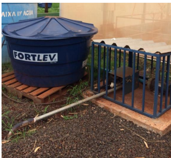
Figura 4. Bomba de ar do sistema de aquaponia.
