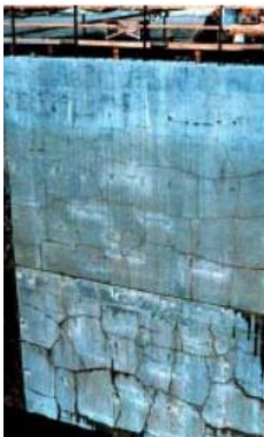
Figura 4 - Fissuração devido a movimentação térmica [25]
