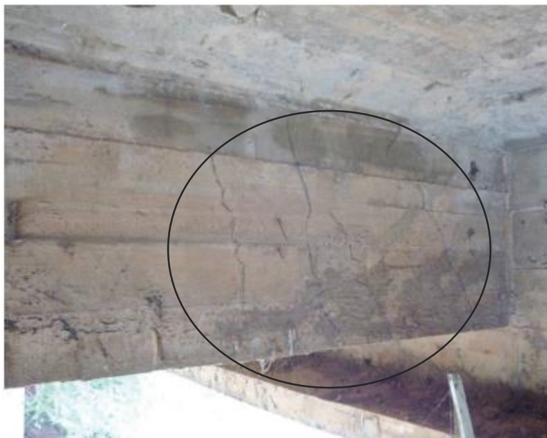
Figura 3 - Fissuras por cisalhamento em ponte, provocadas devido a passagem de veículos com cargas excessivas, não prevista no projeto [22]
