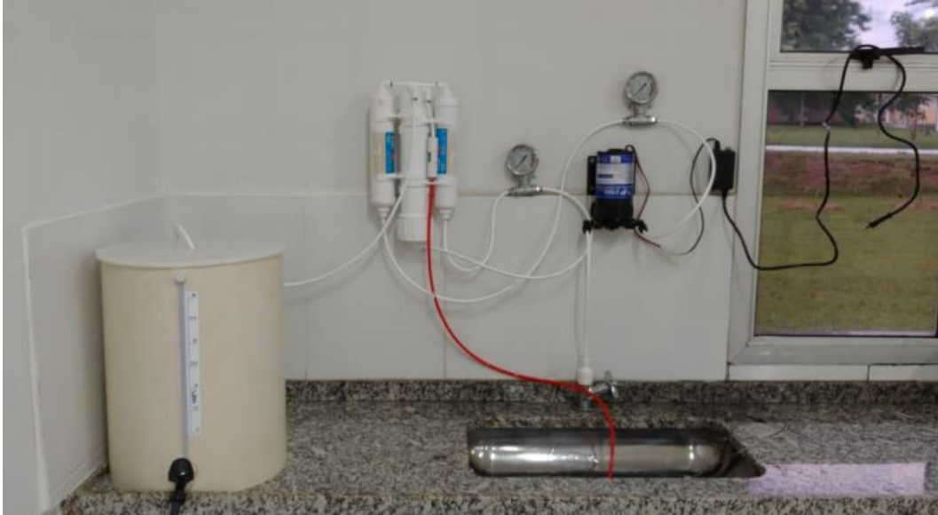
Figura 12. Sistema de filtração com membrana de osmose inversa.
