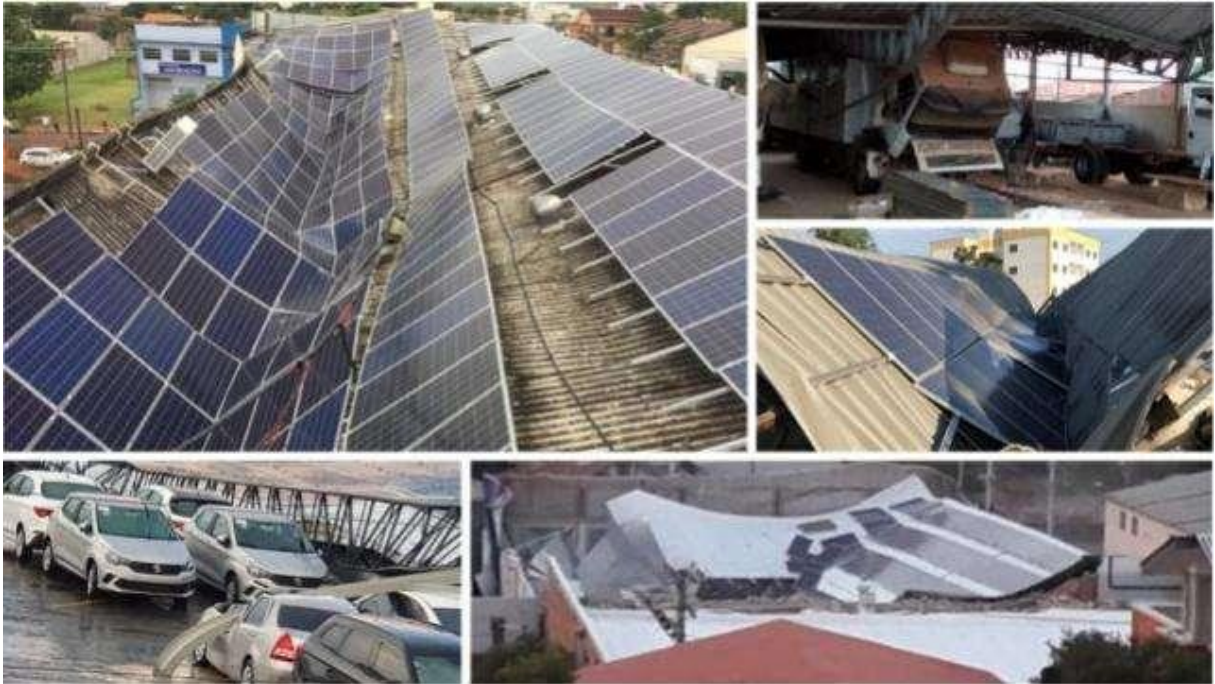
Figura 12 - Desabamentos de coberturas após instalação de painéis fotovoltaicos Fonte: Canal Solar, 2020
