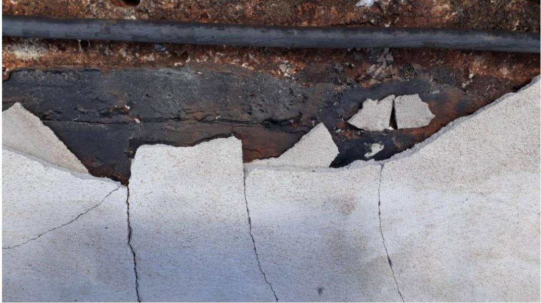
Figura 06: Erro de execução da manta asfáltica Fonte: Próprio autor
