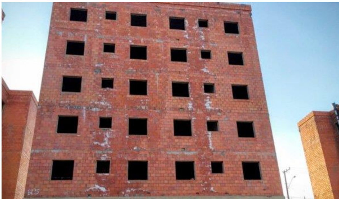
Figura 05: Edificação com eflorescência Fonte: Ligablog, 2016
