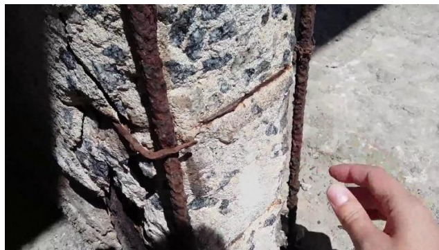
Figura 04: Pilar com armadura exposta Fonte: Tecnosil, 2020
