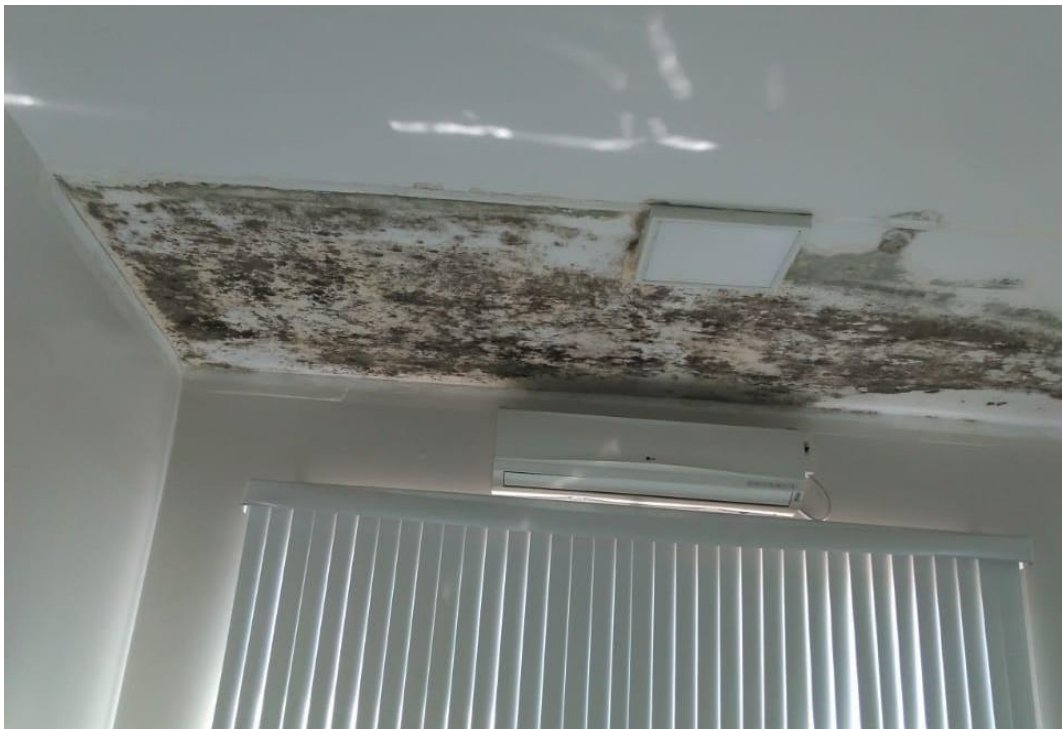
Figura 07: Manifestações patológicas devido a umidade Fonte: Próprio autor
