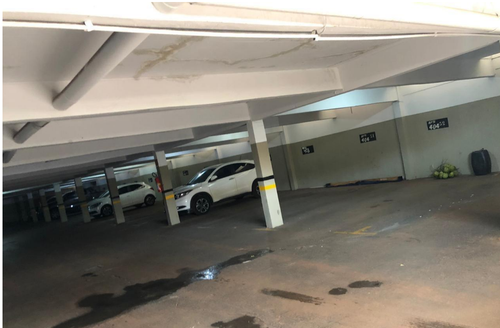
Figura 12: Manifestações patológicas na garagem do subsolo Fonte: Próprio autor
