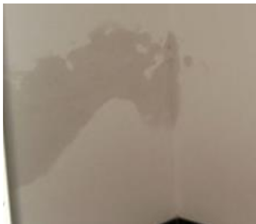
Figura 02: Parede com manchas Fonte: Ibraclube, 2016
