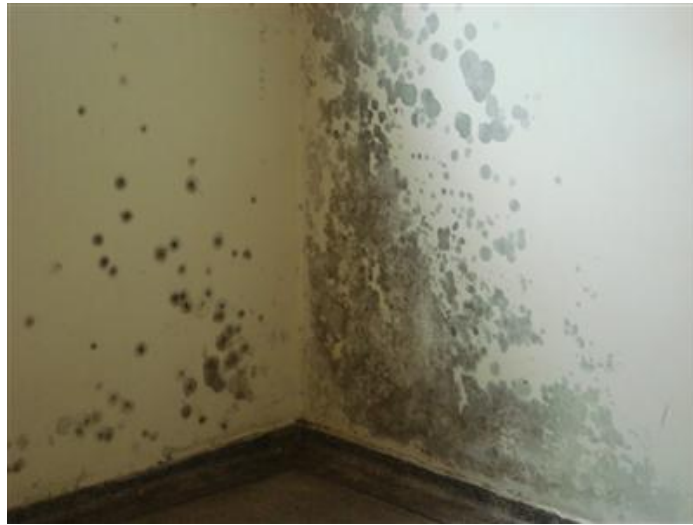
Figura 03: Parede com mofo Fonte: Ibraclube, 2016
