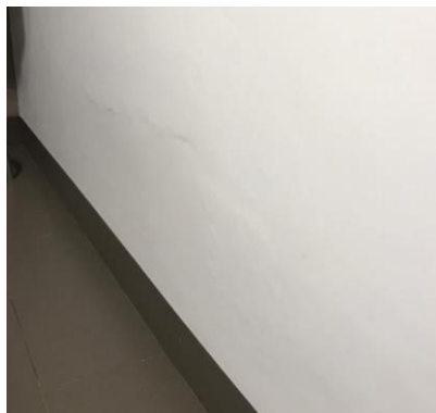
Figura 09: Mal acabamento da pintura devido a erro construtivo Fonte: Próprio autor
