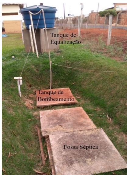
Figura 8 - Tratamento primário de tanque séptico seguida por tanque de bombeamento e de equalização.
