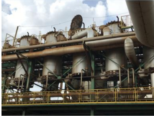
Figura 8. Aquecedores em operação
