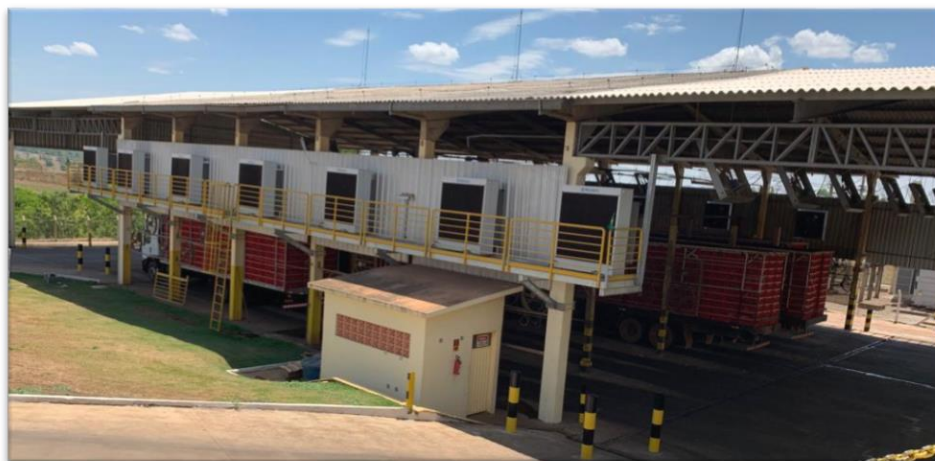
Figura 2: Galpão de espera das aves, sistema de ventilação e climatização por painéis evaporativos. Fonte: Arquivo pessoal.
