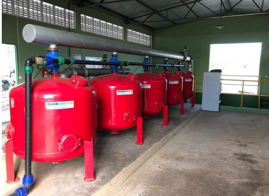
Figura 4.21. Conjunto Filtros de areia. Fonte: Autoria própria (2024).
