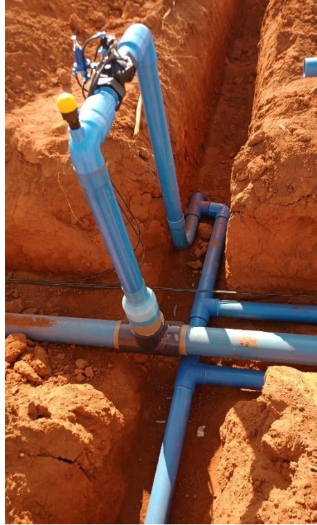
Figura 4.24. Válvulas elétricas. Fonte: Autor Próprio (2024).
