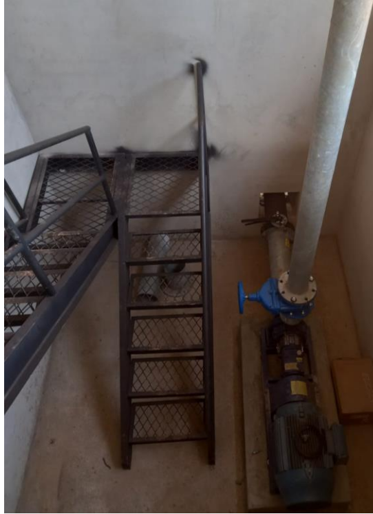
Figura 4.20. Conjunto Motobomba 100CV. Fonte: Autoria própria (2024).
