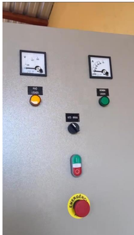
Figura 4.35. Vista externa do painel da motobomba. Fonte: Autor Próprio (2024)
