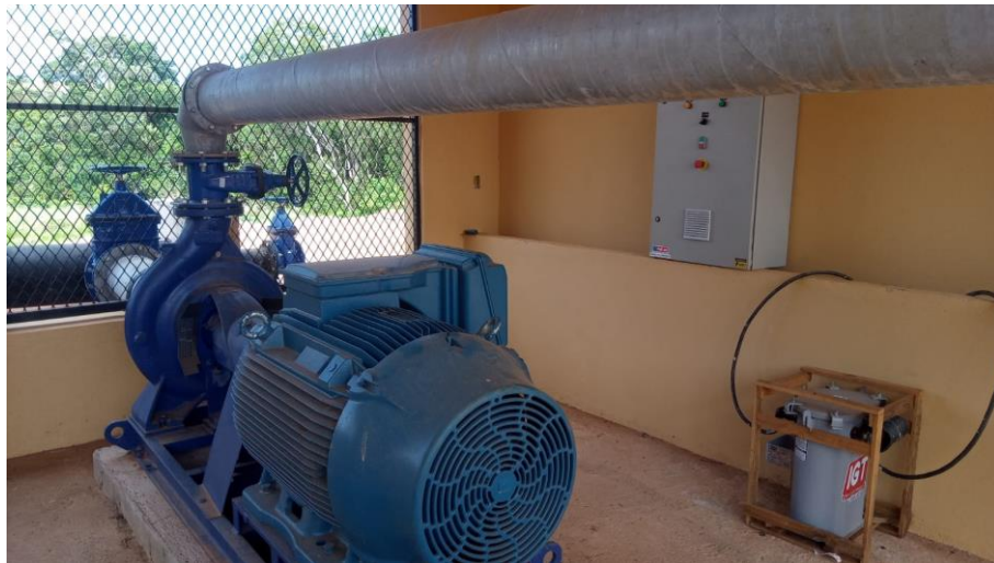
Figura 4.32. Conjunto Motobomba 200cv. Fonte: Autor Próprio (2024).
