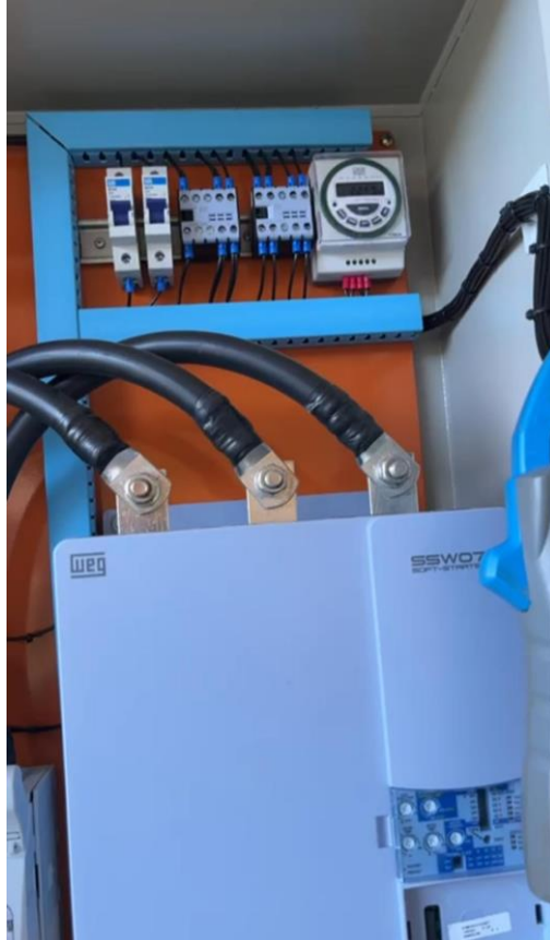
Figura 4.36. Vista interna do painel da motobomba. Fonte: Autor Próprio (2024).
