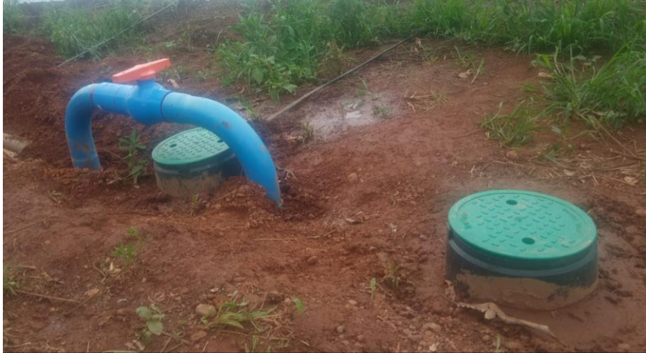
Figura 4.22. Registro de abertura e fechamento do setor. Fonte: Autor Próprio (2024).
