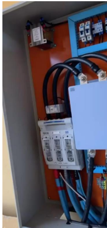
Figura 4.37. Vista interna do painel da motobomba. Fonte: Autor Próprio (2024).
