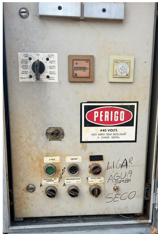
Figura 4.31. Parte externa do painel do pivô. Fonte: Autor Próprio (2024).
