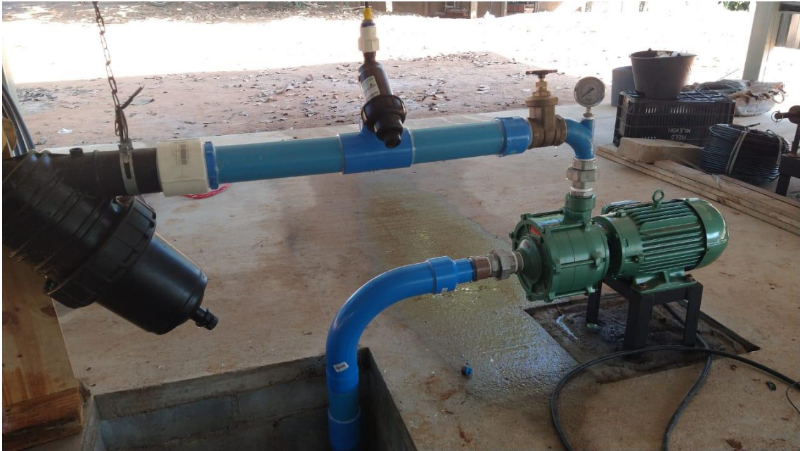
Figura 4.6. Conjunto Motobomba Atual com maior eficiência e controle. Fonte: Autor Próprio (2024).
