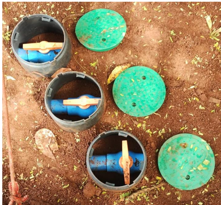
Figura 4.4. Registros manuais PVC. Fonte: Autor Próprio (2024).
