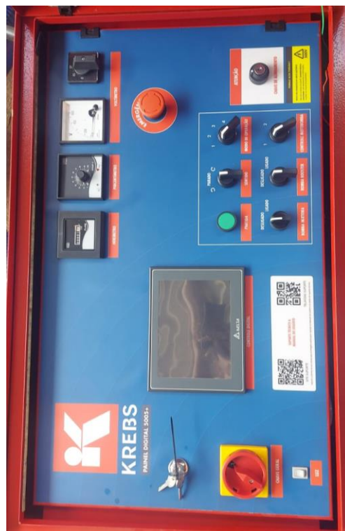
Figura 4.33. Vista externa do painel do pivô. Fonte: Autor Próprio (2024).
