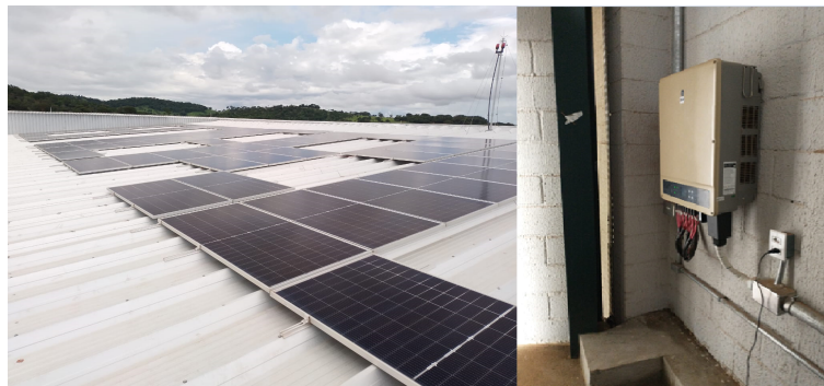
Figura 5.21 - Placas montadas e circuito CC encaminhado até o inversor.
